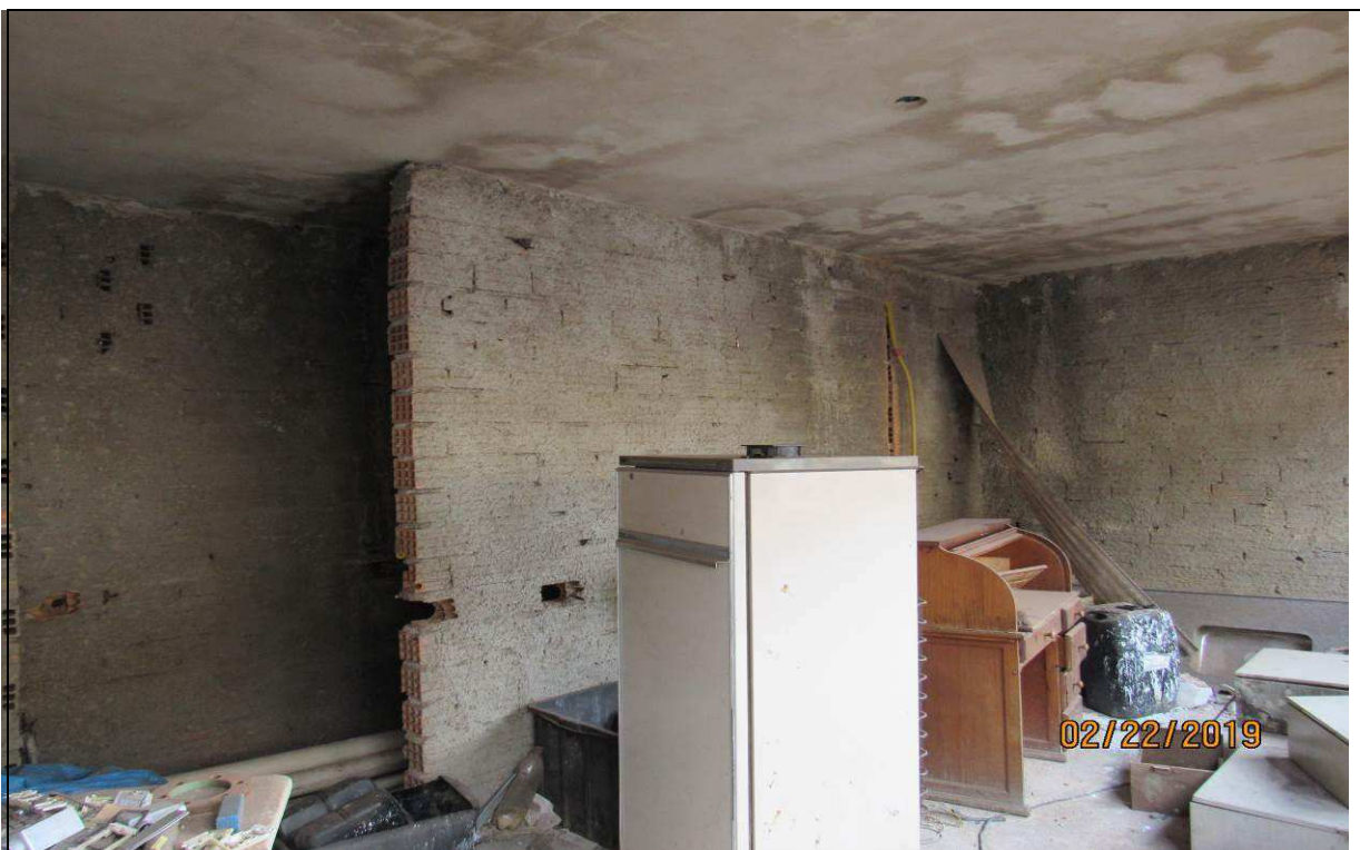
FOTO 11 – Vista interna do sobrado inacabado com poucas partes rebocadas.
