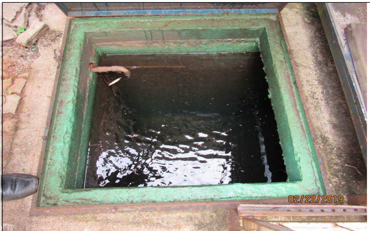
FOTO 07 – Vista da cisterna de 20 mil litros para captação e reaproveitamento das águas pluviais.
