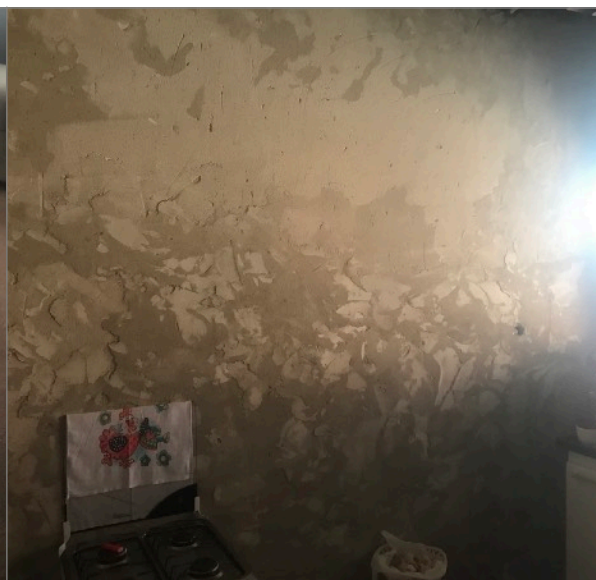
Imagem 05 – Ilustra parede da cozinha sem revestimento cerâmico e reboco rústico.
