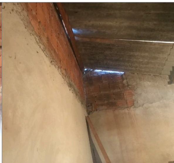
Imagem 07 – Tomada fotográfica obtida do dormitório. detalhe para ausência de forro.
