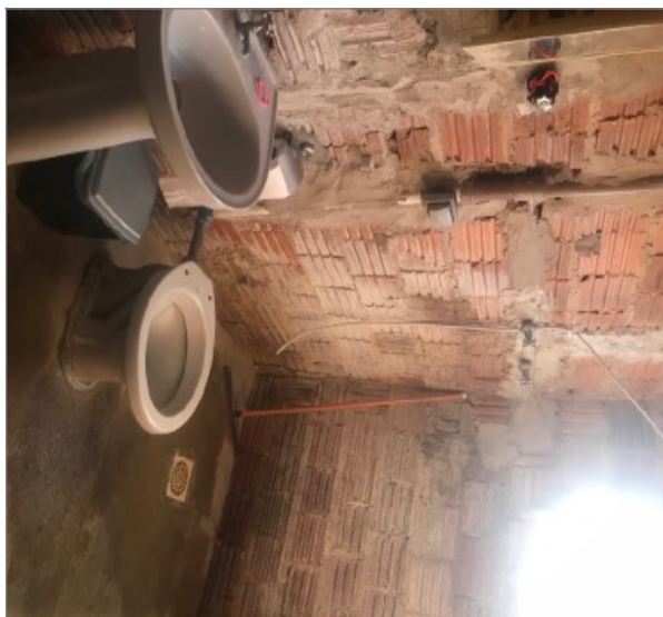
Imagem 06 – Banheiro não possui revestimento nas paredes. Piso cimentado. Detalhe para tubulações parcialmente embutidas.
