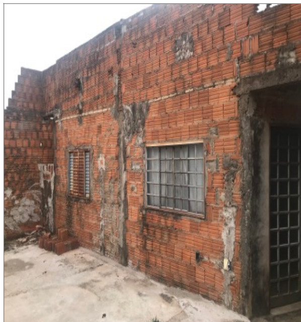
Imagem 02 – Ilustra fachada frontal. Ausência de reboco. Esquadrias de padrão popular.
