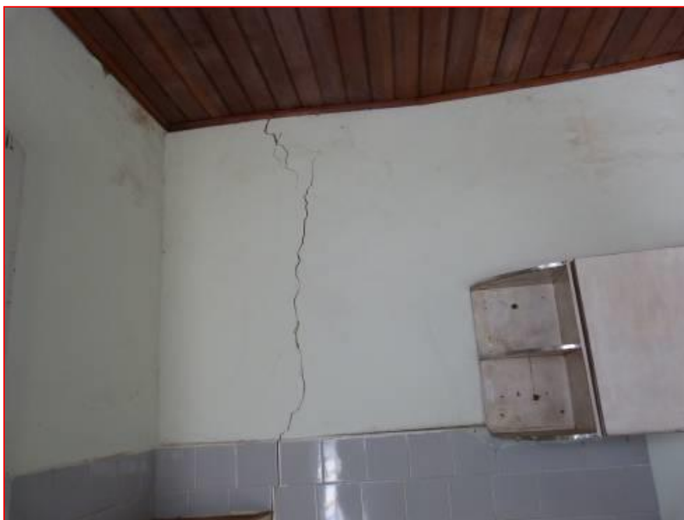
Foto 12: Detalhe de uma rachadura na parede lateral esquerda da cozinha.
