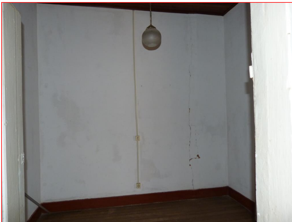
Foto 08: Vista do cômodo lateral direito com entrada pelo corredor. Notar a existência de uma trinca vertical na parede.
