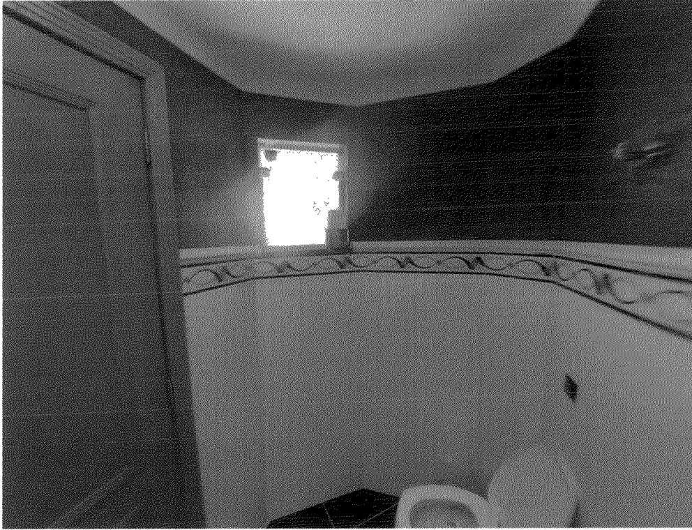
Foto 22: lavabo- 1º Pavimento
