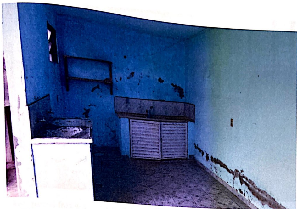
Vista parcial interna da residência sob o nº 1.077, observando a área de serviço.
