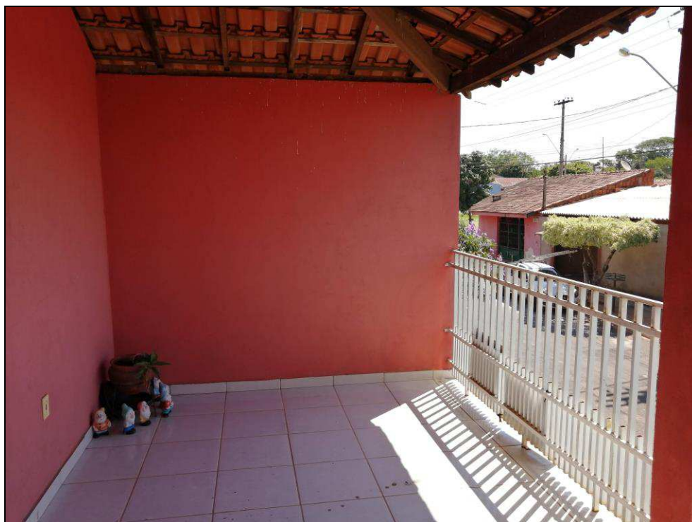
FOTO Nº 10:- Detalhe parcial da varanda existente no pavimento superior, onde podemos observar as principais características construtivas e o estado de uso e conservação.
