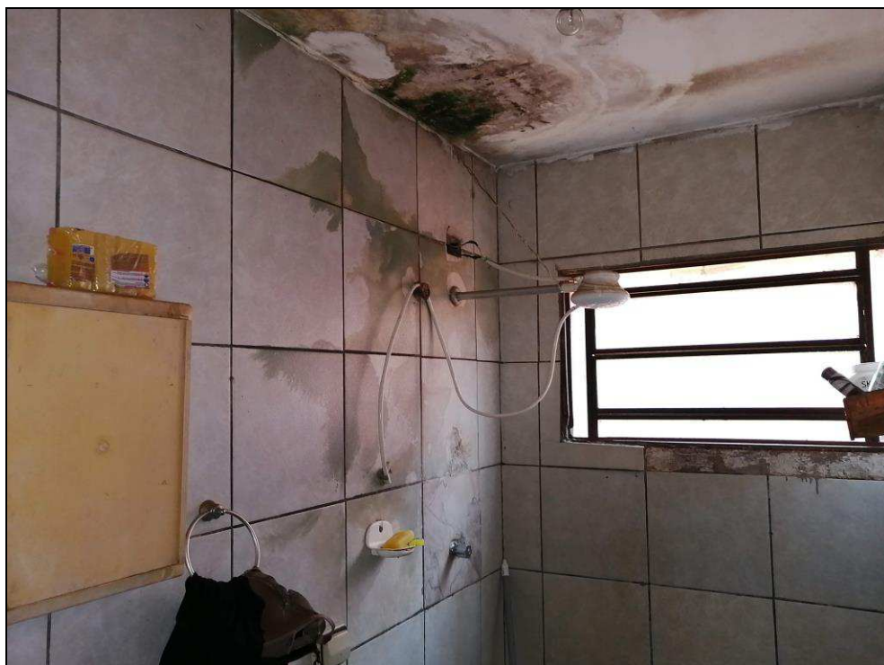
FOTO Nº 04:- Detalhe parcial do banheiro existente no pavimento térreo, onde podemos observar o estado de conservação. Nota-se infiltrações generalizadas pela laje do forro e nas paredes.
