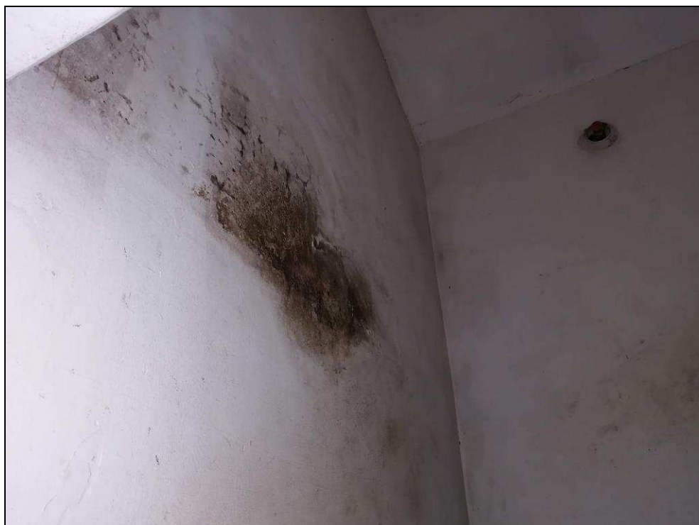
FOTO Nº 06:- Detalhe parcial do um dos dormitórios. Observa-se que o imóvel não dispõe de forro.
