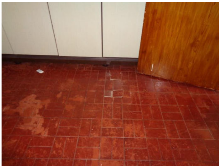
Quarto: piso cerâmico com algumas peças soltas.
