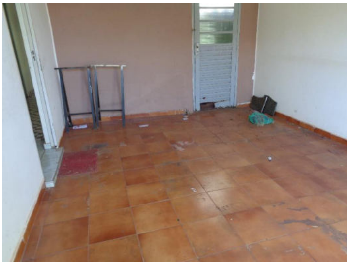
Vista de parte da garagem: piso cerâmico, paredes reboco com pintura, forro laje. Ferrugem na parte inferior da porta.
