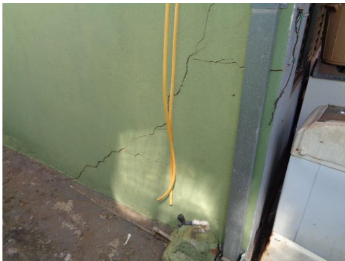
Trinca de recalque.
