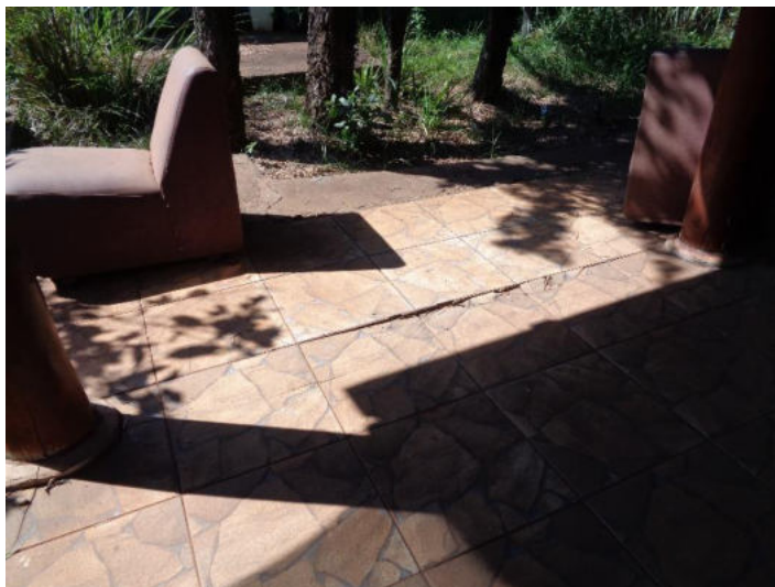
Parte da cobertura depois da copa: Parte do piso aparentemente "afundando".
