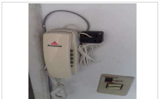
INTERFONE NECESSITA MANUTENÇÃO
