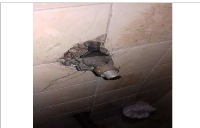
BANHEIRO (NECESSITA REFORMAS HIDROSANITÁRIO)
