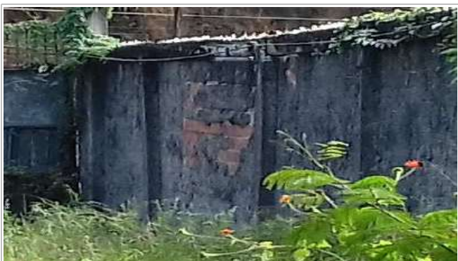
TRECHO MURO C/ DEFORMAÇÃO (JUNTO AO CÔRREGO MANILHADO)
