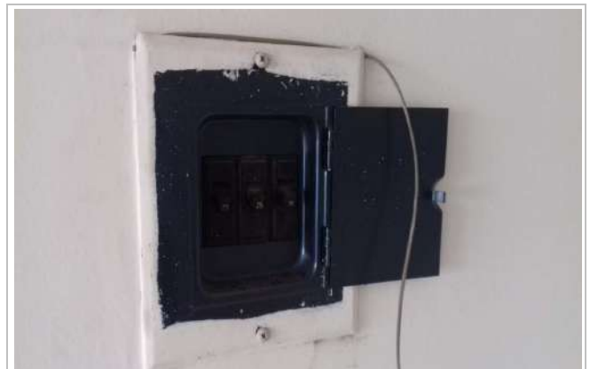
QDL (AVALIANDO NECESSITA REFORMAS NA ELÉTRICA)
