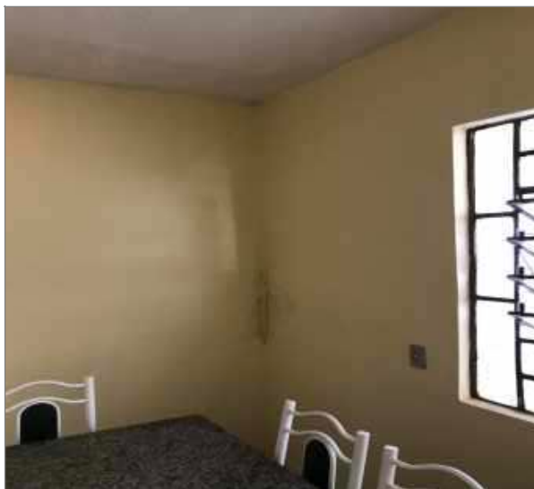
Imagem 07 – Ponto de infiltração na parede da copa.
