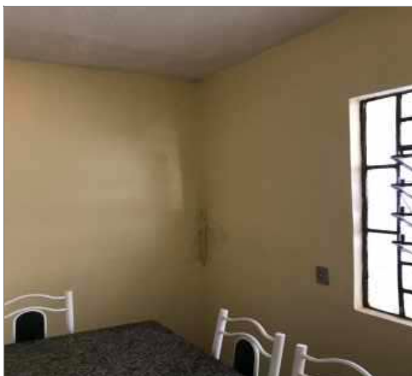
Imagem 07 – Ponto de infiltração na parede da copa.
