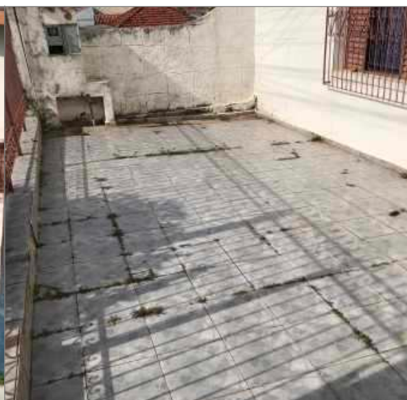
Imagem 06 – Vista parcial do recuo frontal, ilustrando piso cerâmico comum e estado de conservação.
