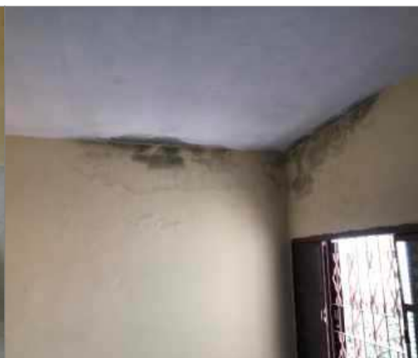
Imagem 10 – Dormitório dos fundos apresenta infiltração pela cobertura.
