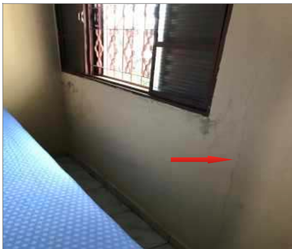
Imagem 11 – Dormitório dos fundos possui infiltração na parede ao redor da janela. Detalhe para trinca vertical.
