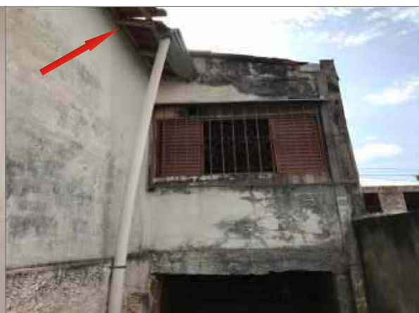
Imagem 16 – fachada dos fundos. Revestimento de argamassa (reboco) apresenta muitas fissuras e desgaste excessivos da pintura. Detalhe para beiral do telhado avariado.
