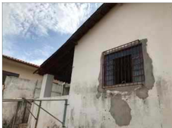
Imagem 15 – Ilustra fachada dos fundos. Detalhe para desgaste excessivo da pintura.
