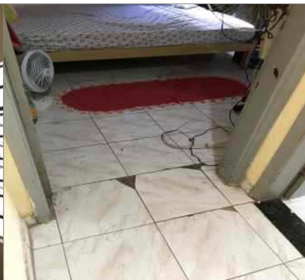
Imagem 08 – Ilustra piso cerâmico encontrado no interior da edificação e estado de conservação.
