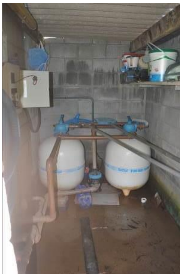
Foto 24: Vista interna casa de máquinas.
