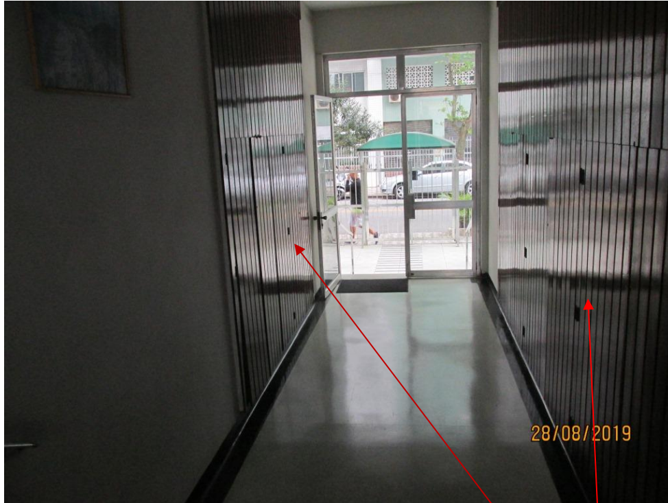
Foto 4 - Hall de entrada e quadro dos medidores
