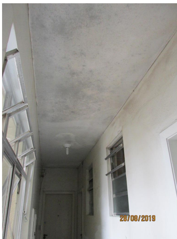
Foto 13 - Manchas de umidade no teto da área de circulação
