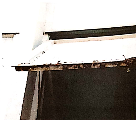
Imagem 47 – detalhe de esquadria em estado avançado de oxidação
