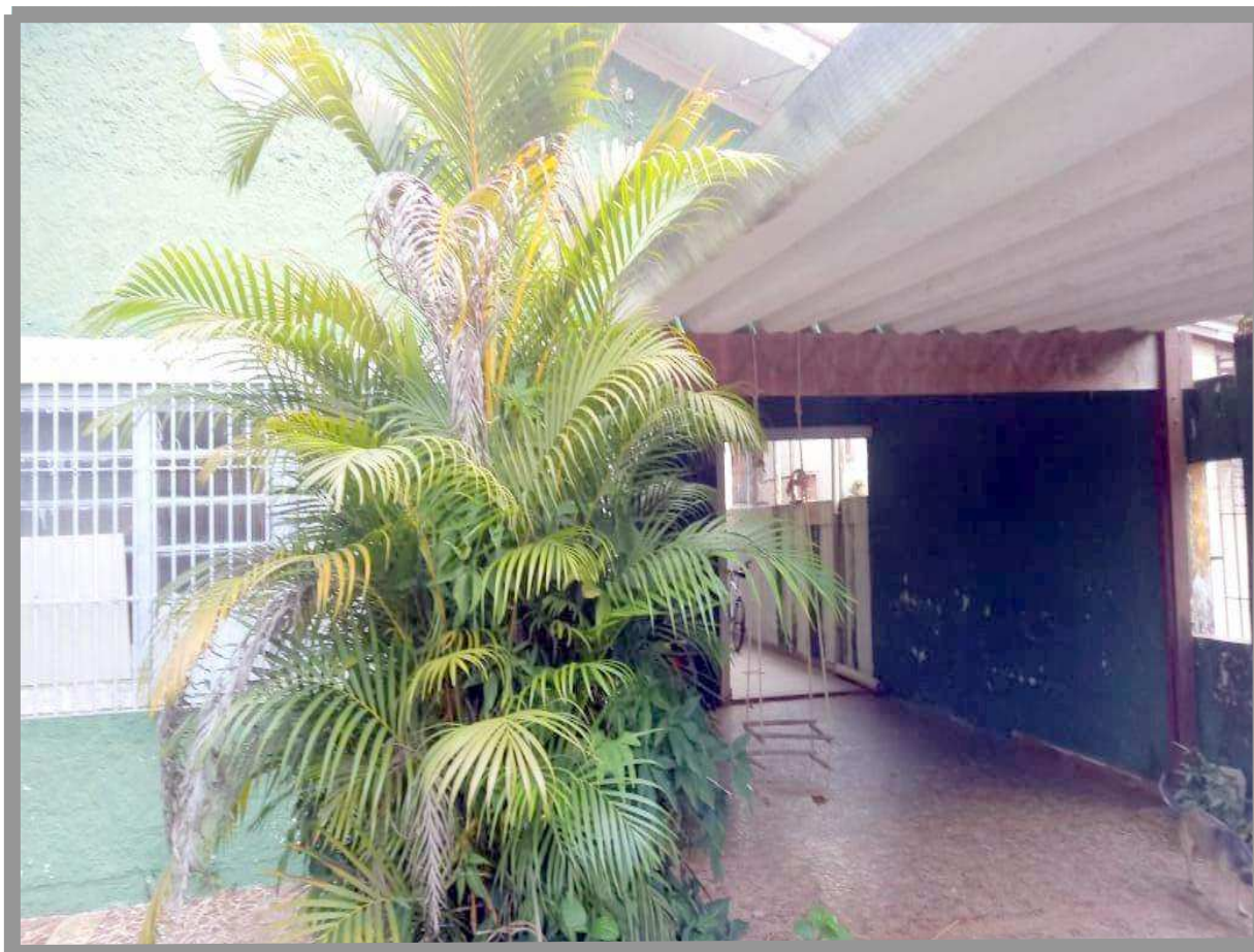
Vista do abrigo para veículos, detalhe da parede necessitando de pequenos reparos.
