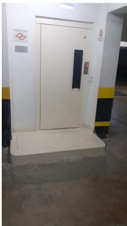
Foto 20 - Vista do elevador social na área comum do Condomínio.
