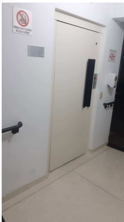
Foto 19 - Vista do elevador de serviços na área comum do Condomínio.
