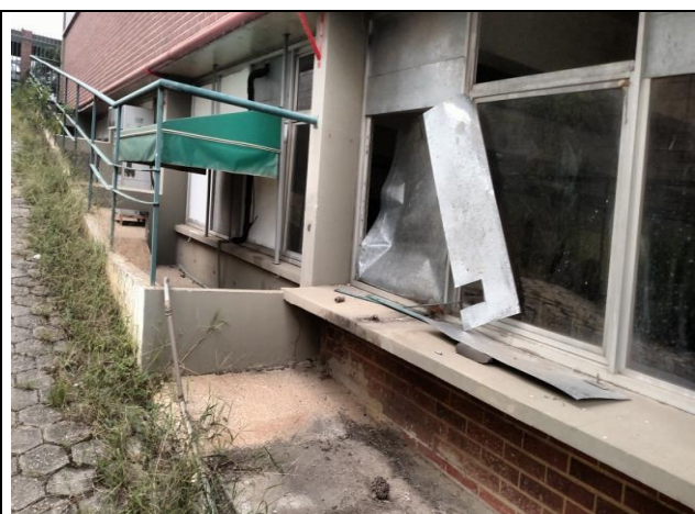
Vista lateral com janelas destruídas e ausência de vidros
