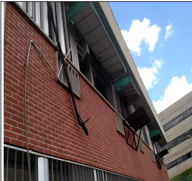
Vista lateral com ausência de vidros e janelas danificadas
