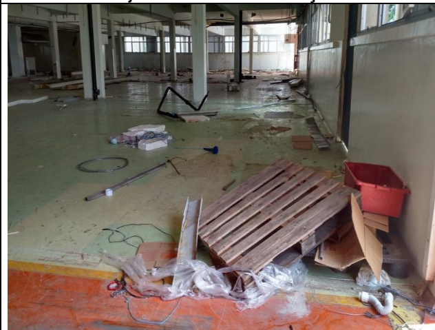
Piso inferior, janelas, iluminação totalmente danificadas
