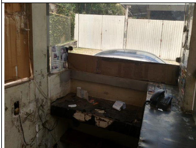
Guarita totalmente danificada: pisos, balcão, banheiro e vidros quebrados
