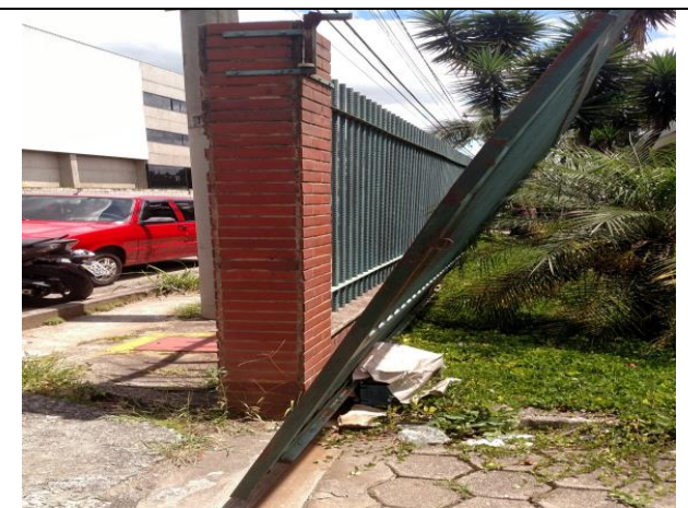
Portão de acesso e motor quebrado
