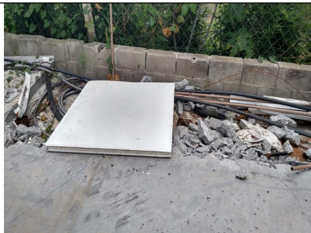
Piso dos fundos destruídos com infiltração, comprometendo muro e vizinhos
