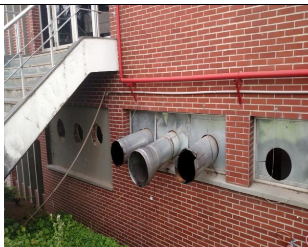
Perfurações para saída de chaminés alterando a fachada do prédio
