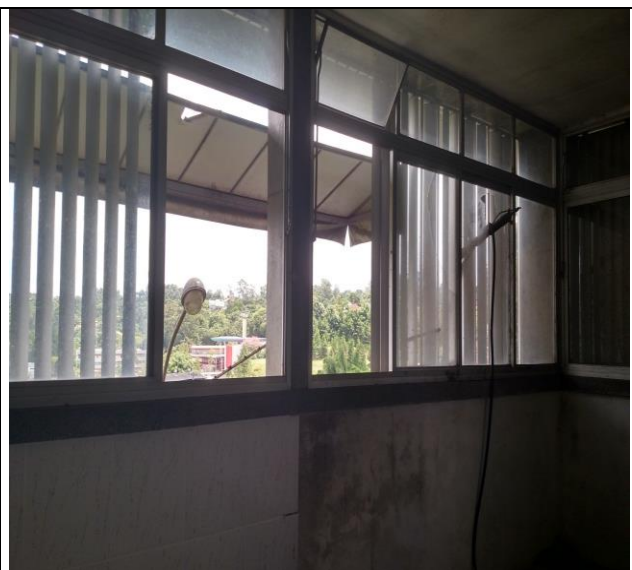
Janelas superiores danificadas com ausência de vidros
