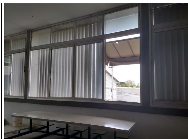
Refeitório – Janelas danificadas
