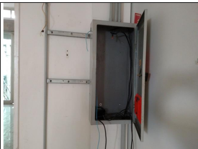
Quadro de energia com ausência de disjuntores e distribuição
