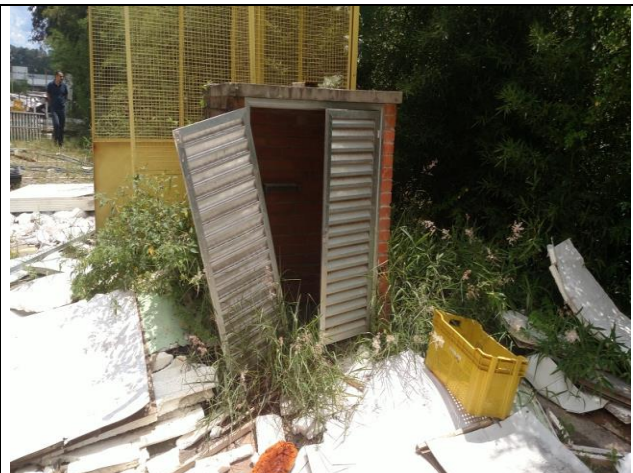
Casa de bomba de incêndio destruída, ausência de bomba e equipamentos
