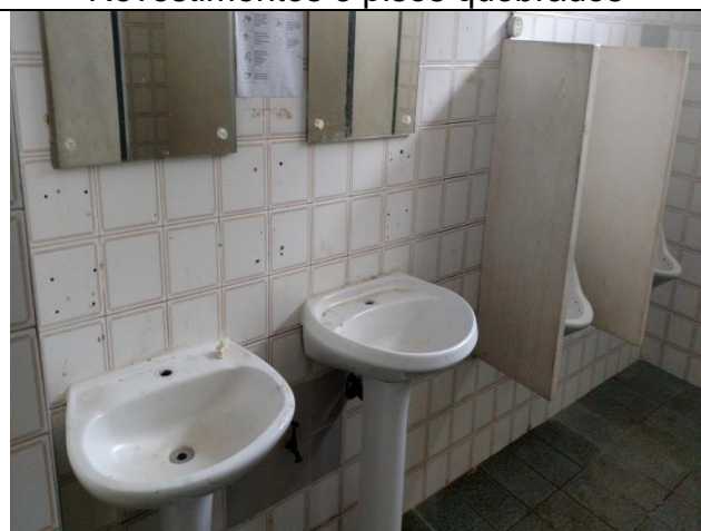
Banheiros totalmente danificados
