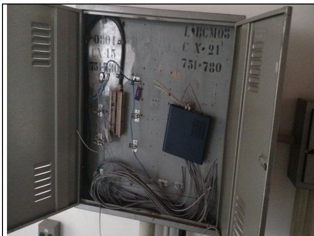
Quadro de energia totalmente danificado com ausência das chaves principais
