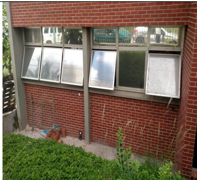
Vista lateral com ausência de vidros e janelas danificadas
