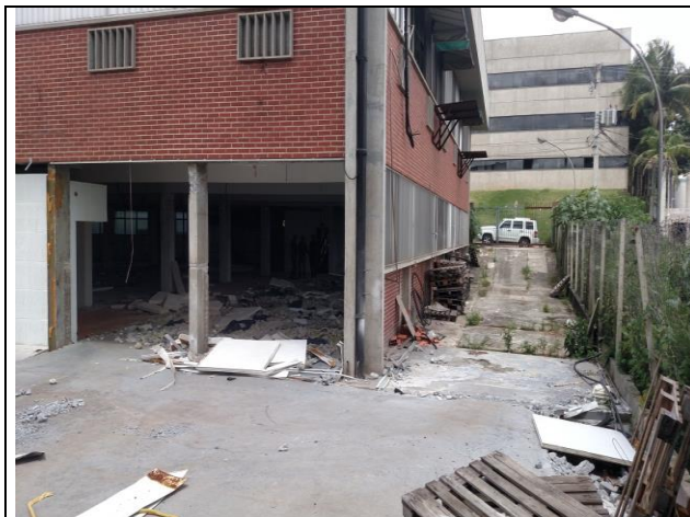
Vista lateral com ausência das portas principais do prédio
