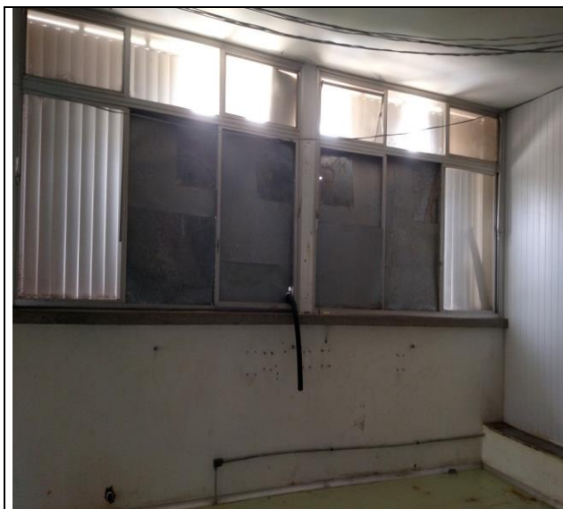
Janelas superiores danificadas com ausência de vidros
