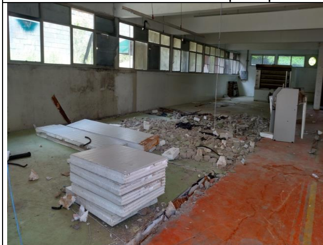
Piso inferior, janelas, iluminação totalmente danificadas
