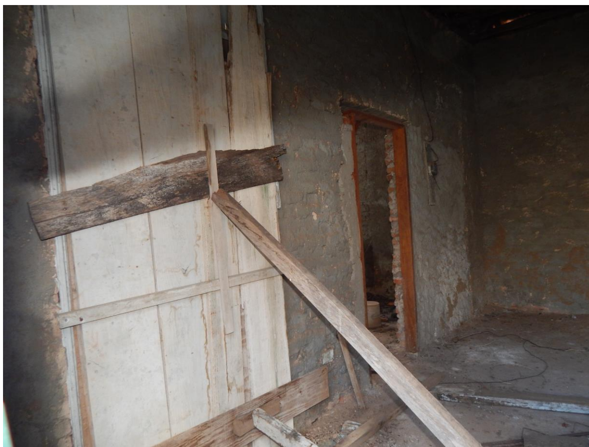
FOTO 06 – Vista interna porta de acesso travada com madeira
