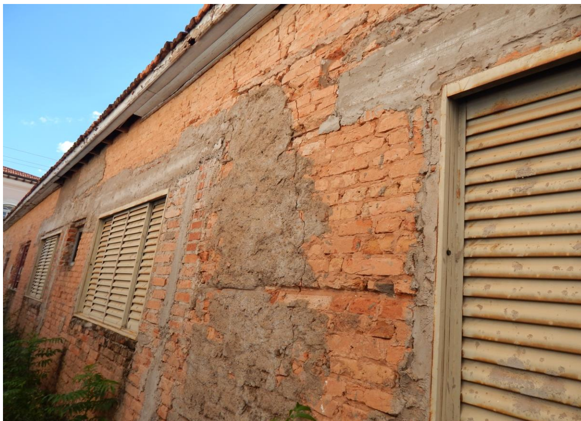
FOTO 15 – Vista lateral parede com trincas
