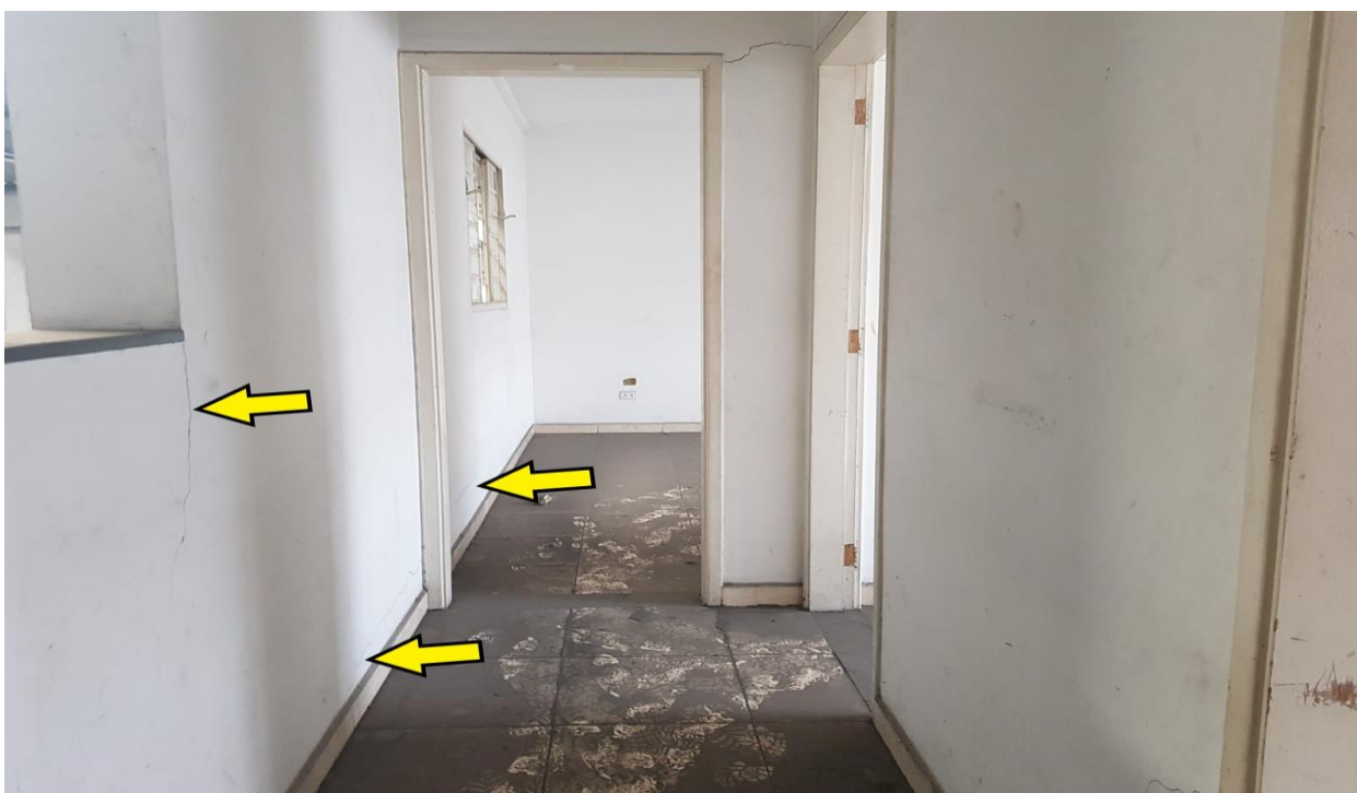
Foto 17 – Hall de acesso às salas da administração – no detalhe, rachaduras
