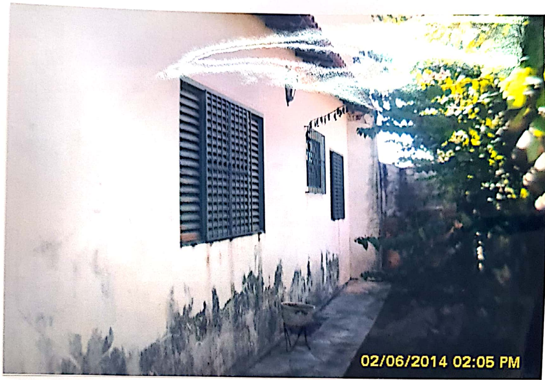
Autos nº 0001191-74.2014.8.26.0201 ÁLBUM ÁREA DE LAZER RUA JOÃO BENTO Foto 67 Vista parcial frente
