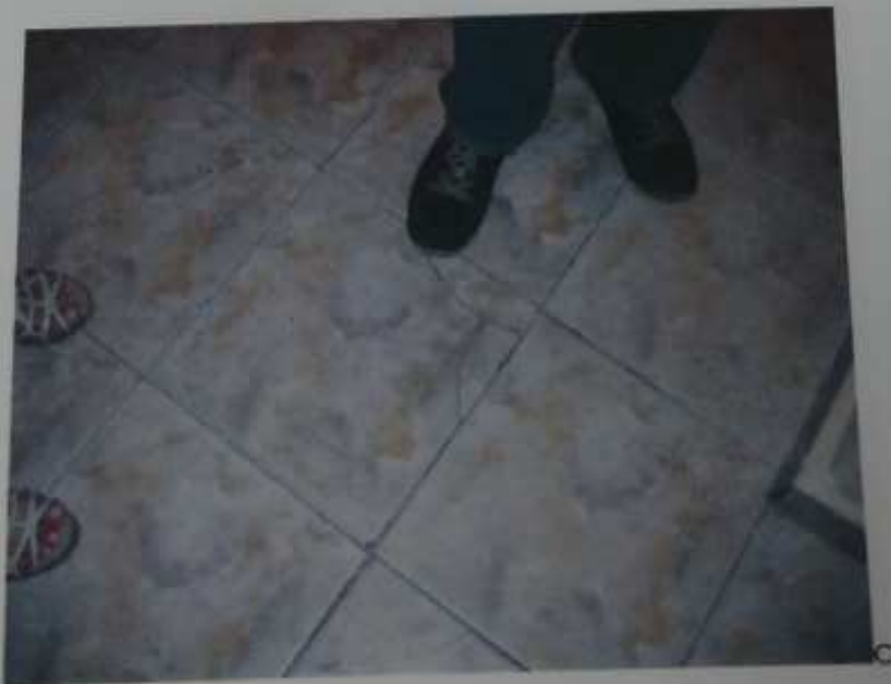
FOTO 05:- Vista interna do imóvel avaliando. Sala. Piso cerâmico com trincas.
