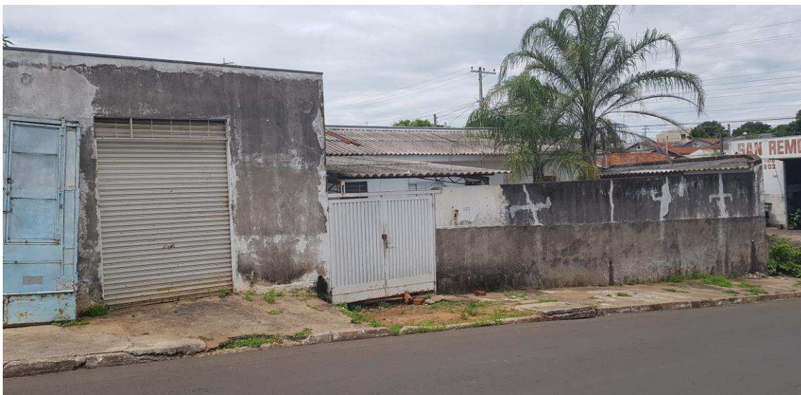
Fachada do imóvel avaliando sito à Rua Alcides Caliman nº 358 x Rua Miguel Pastori.
