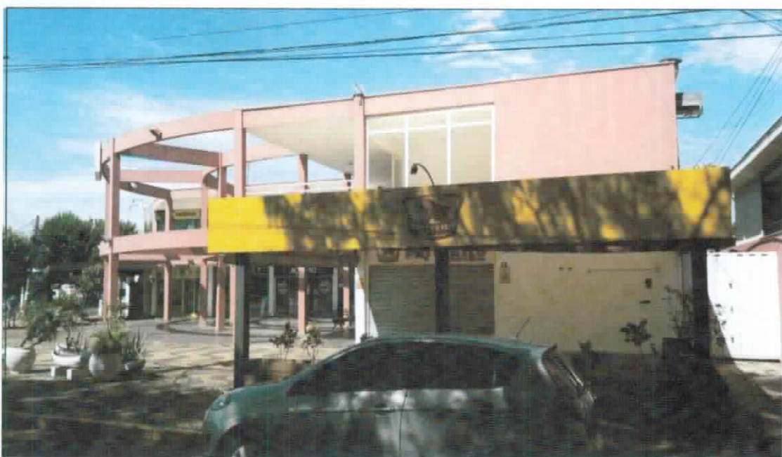
FOTO 08 – VISTA DE LOJA QUE ALTERA A FORMA DA FACHADA DO EDIFÍCIO
