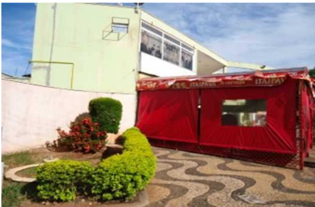
Foto 7: destruição da Fonte originariamente construída. Invasão INADEQUADA da calçada pelo TOLDO DE FECHAMENTO (inovação criada pela LOJA 01).
