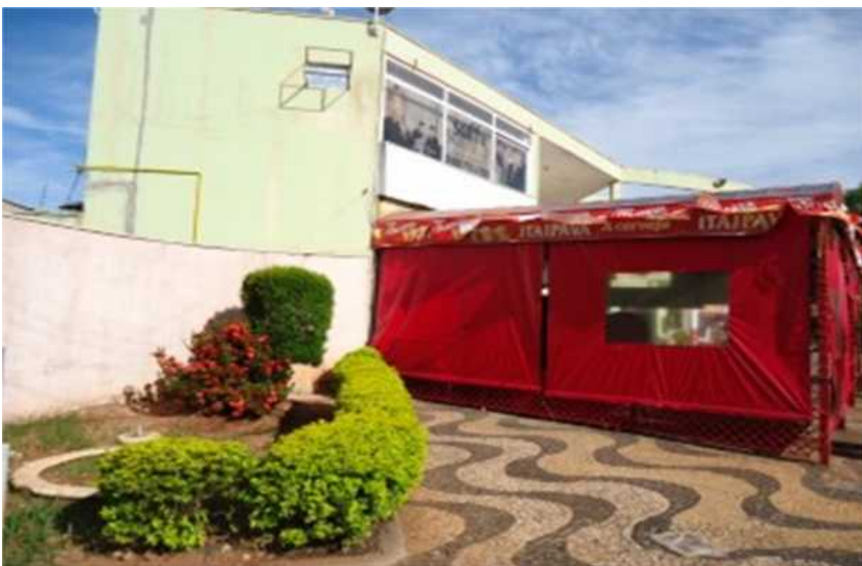
Foto 7: destruição da Fonte originariamente construída. Invasão INADEQUADA da calçada pelo TOLDO DE FECHAMENTO (inovação criada pela LOJA 01).
