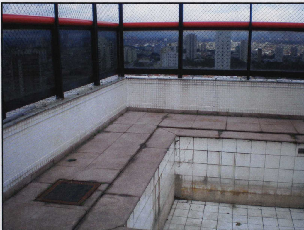
foto nº01: A piscina existente no pavimento superior do apartamento duplex, na área livre aberta; salienta-se que a mesma encontrava-se vazia e desativada.
