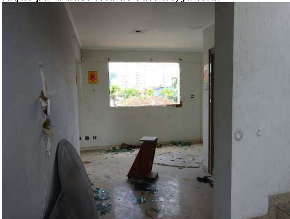
FOTO 11: Segundo Pavimento: Vista parcial de hall com destaque para ausência de batente, janela.
