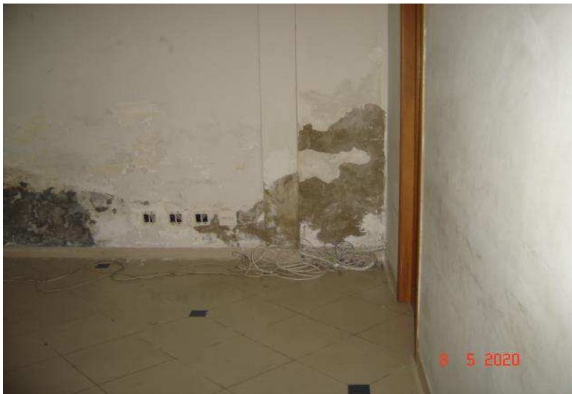
5 – Pavimento térreo. Descolamento de massa devido ao excesso de umidade junto ao piso.
