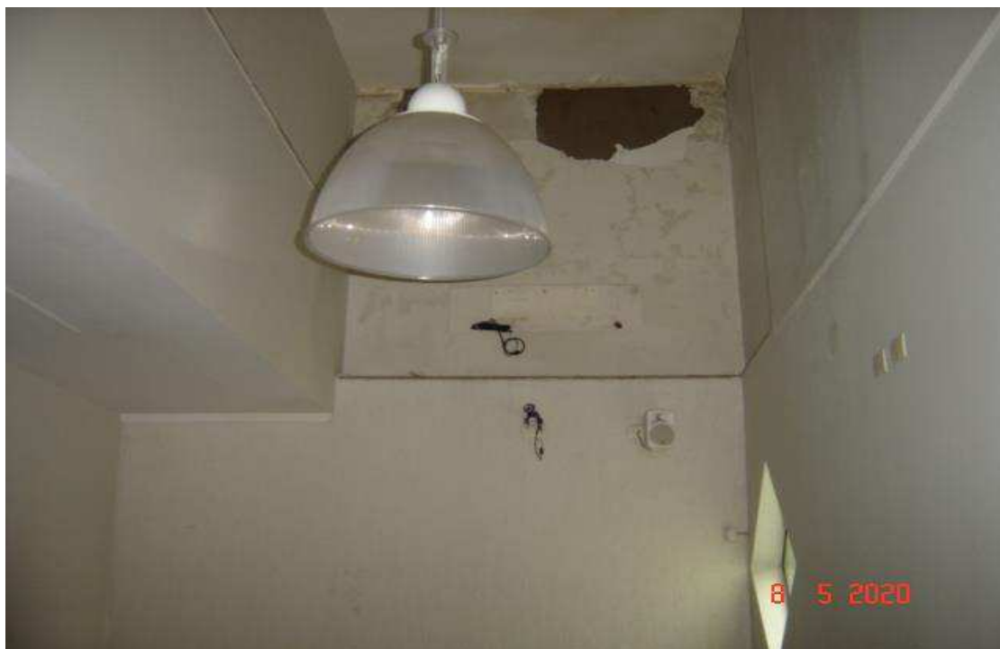
4 – Pavimento térreo, após a entrada. Descolamento de massa, devido excesso de umidade.
