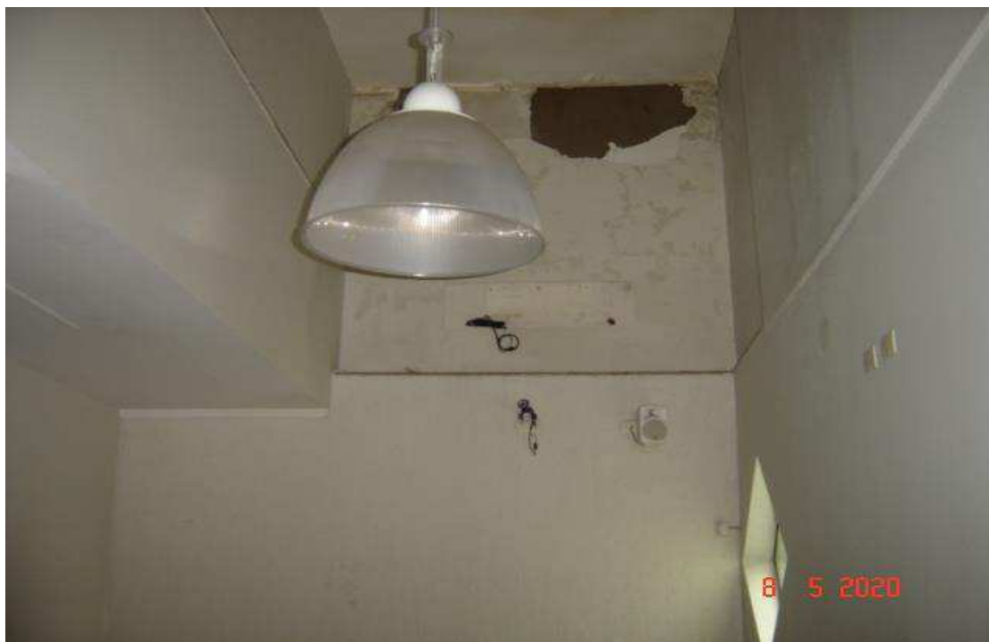
4 – Pavimento térreo, após a entrada. Descolamento de massa, devido excesso de umidade.
