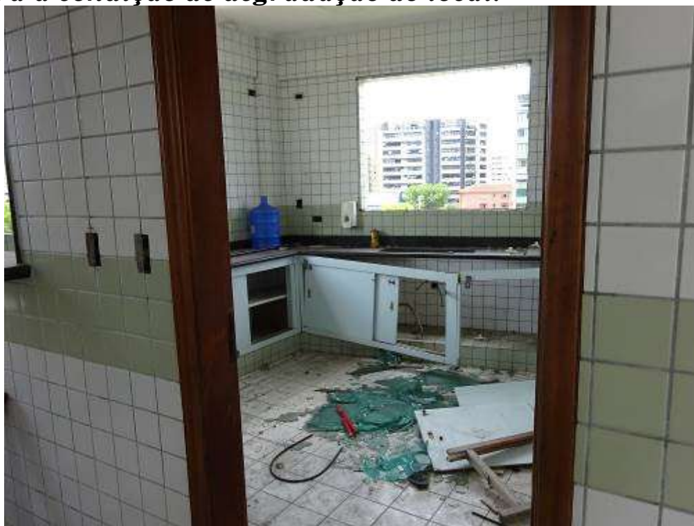
FOTO 15: Cobertura: Vista parcial da cozinha. Destaque para a condição de degradação do local.
