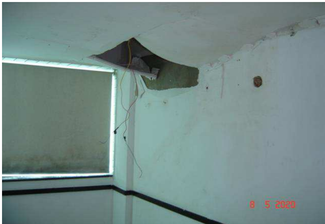
15 – Segundo andar. Queda de forro e descolamento de massa nas paredes, devido a umidade.
