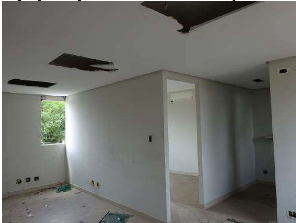
FOTO 10: Primeiro Pavimento: Vista parcial de salas. Destaque para o péssimo estado de conservação do local.
