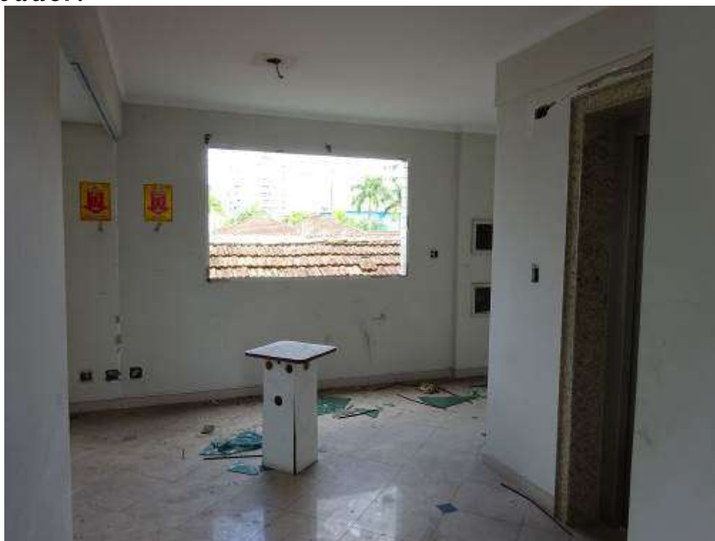
FOTO 09: Primeiro Pavimento: Vista parcial de hall com destaque para ausência de batente, janela e porta do elevador.
