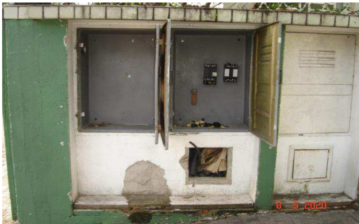
26 – Cabine de energia, sem equipamentos de medição da Concessionária de energia.
