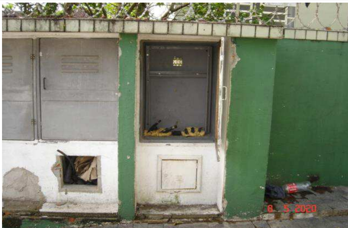
27 – Cabine de energia, sem o quadro de distribuição elétrica.
