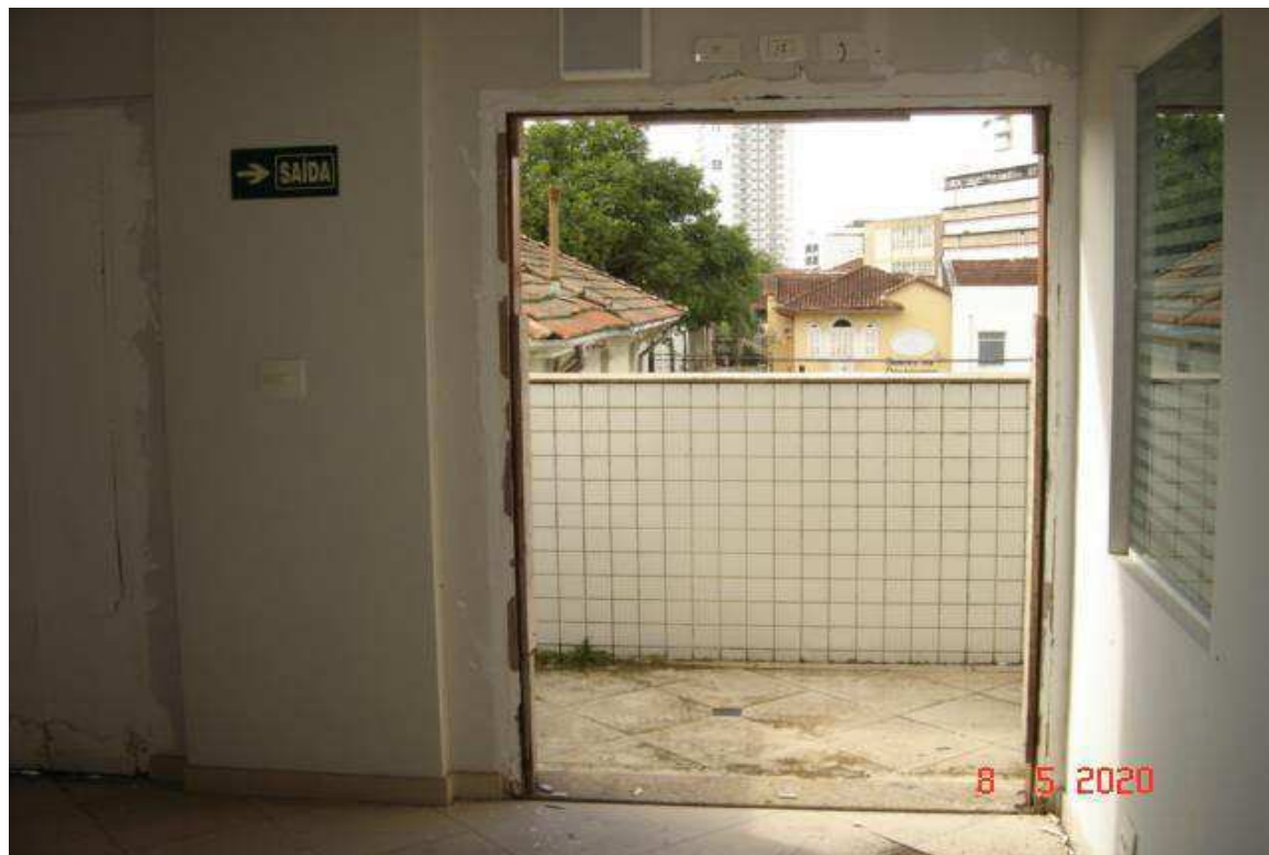
17 – Terceiro andar. Porta inexistente. Há entrada de chuva, facilitando a propagação de umidade.
