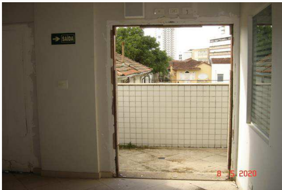
17 – Terceiro andar. Porta inexistente. Há entrada de chuva, facilitando a propagação de umidade.
