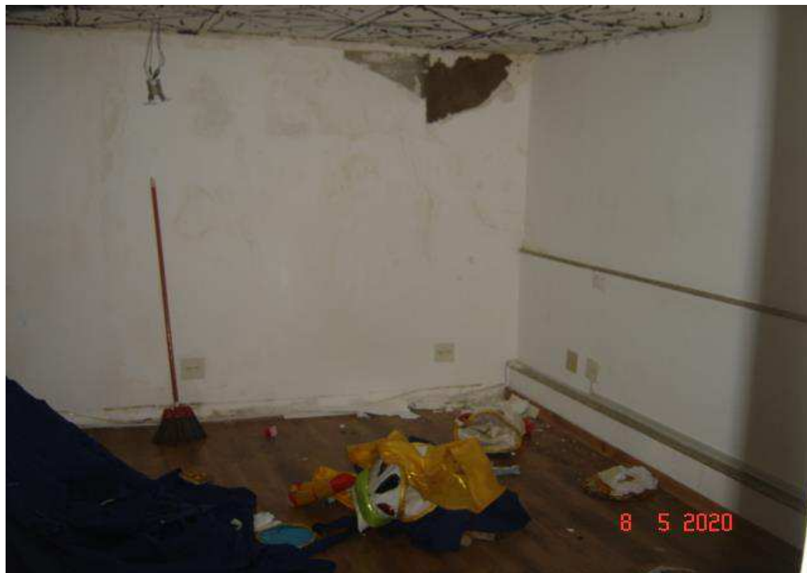
13 – Segundo andar. Muita umidade, descolamento de massa e forro solto. Presença de restos de fantasias.
