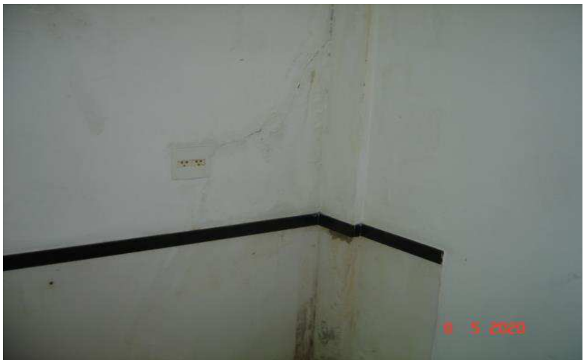
14 – Segundo andar. Muita umidade, descolamento de massa e tomadas com umidade.
