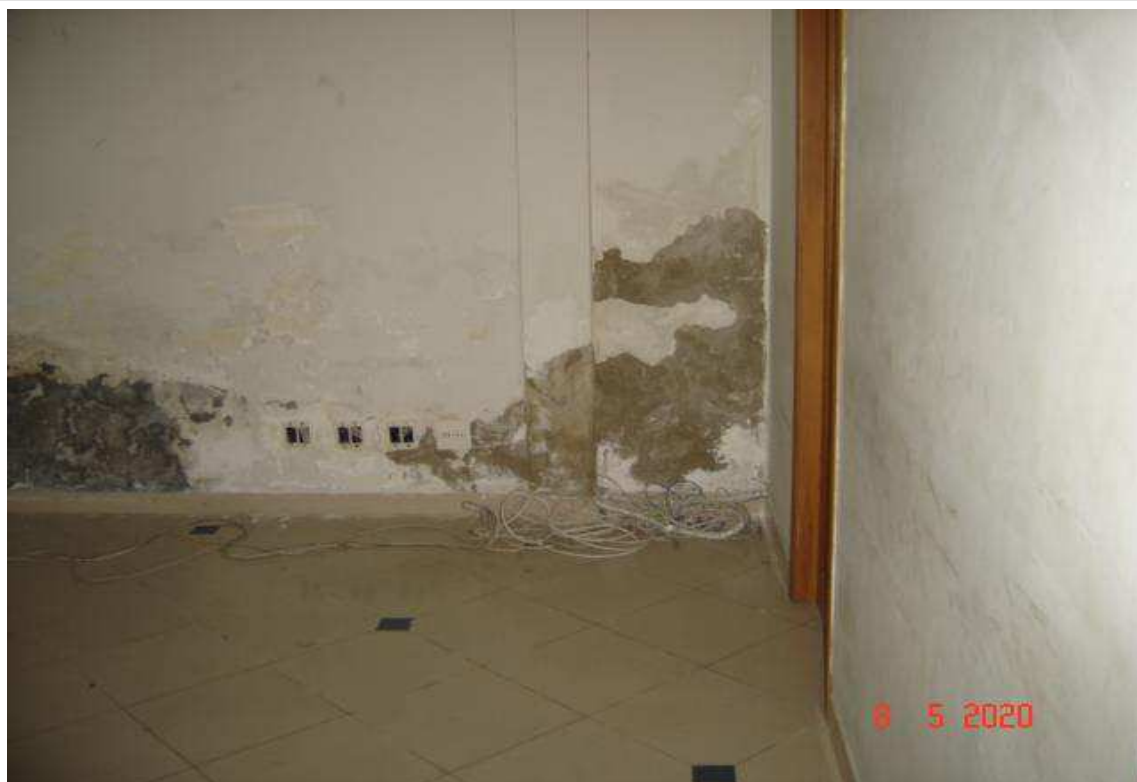
5 – Pavimento térreo. Descolamento de massa devido ao excesso de umidade junto ao piso.
