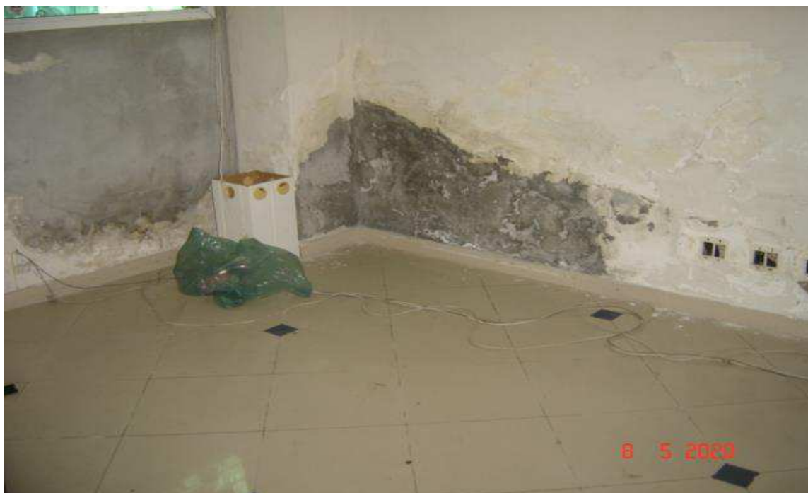
6 – Pavimento térreo. Descolamento de massa devido ao excesso de umidade.
