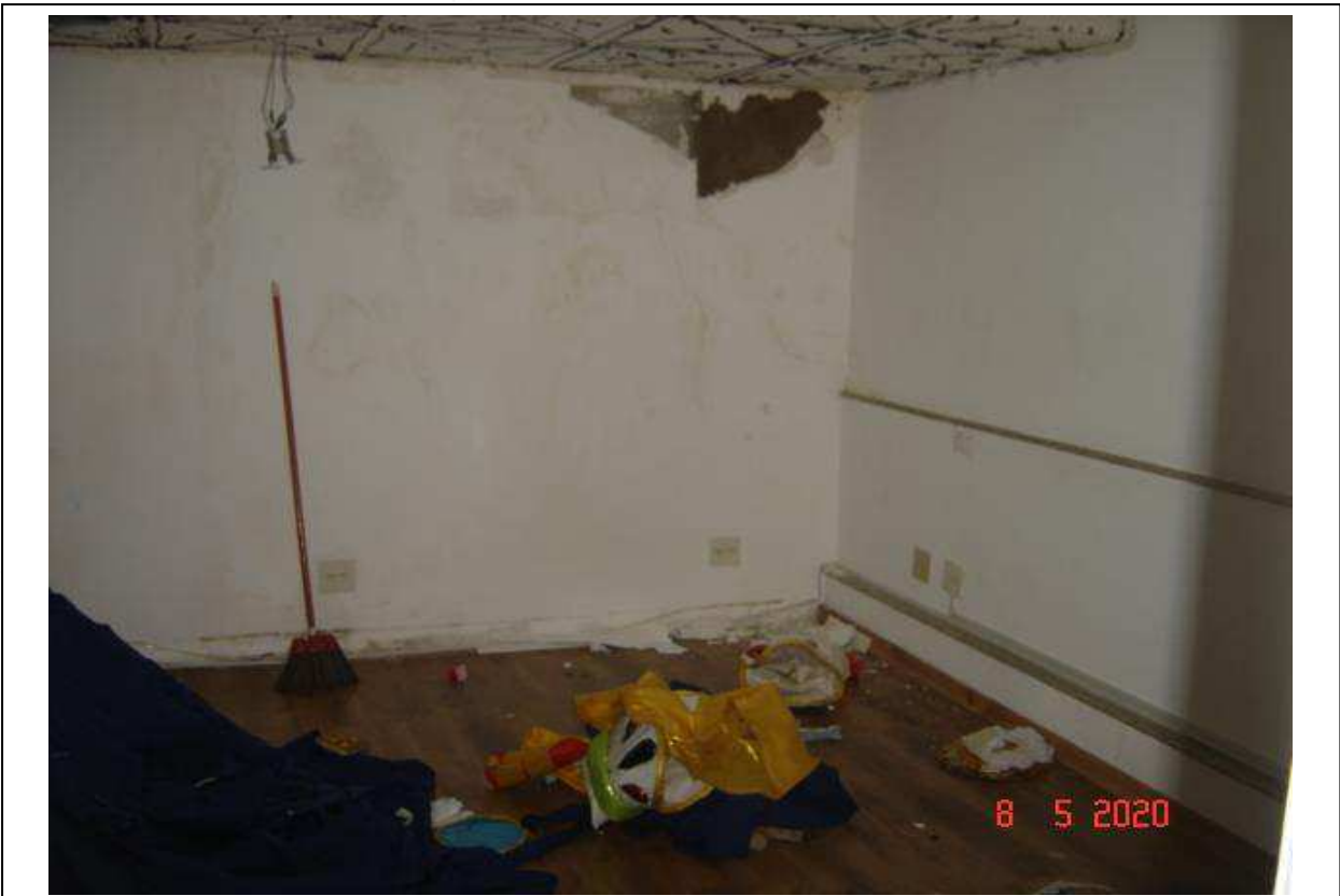
13 – Segundo andar. Muita umidade, descolamento de massa e forro solto. Presença de restos de fantasias.
