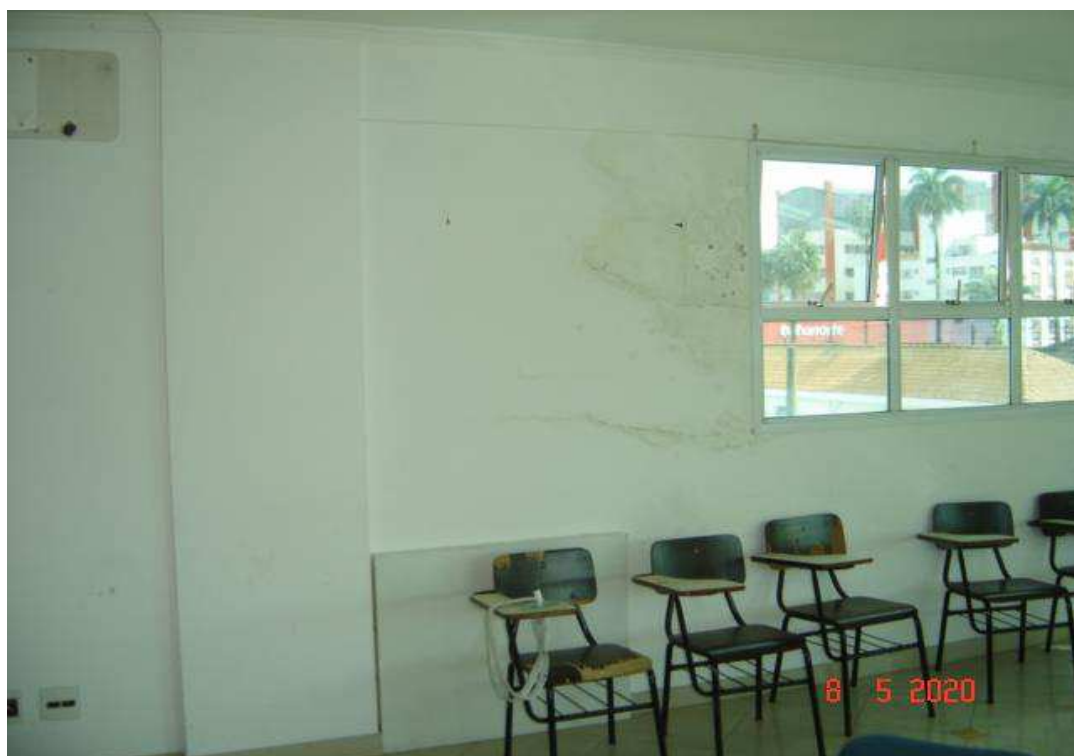
20 – Sala de reuniões. Umidade nas paredes.
