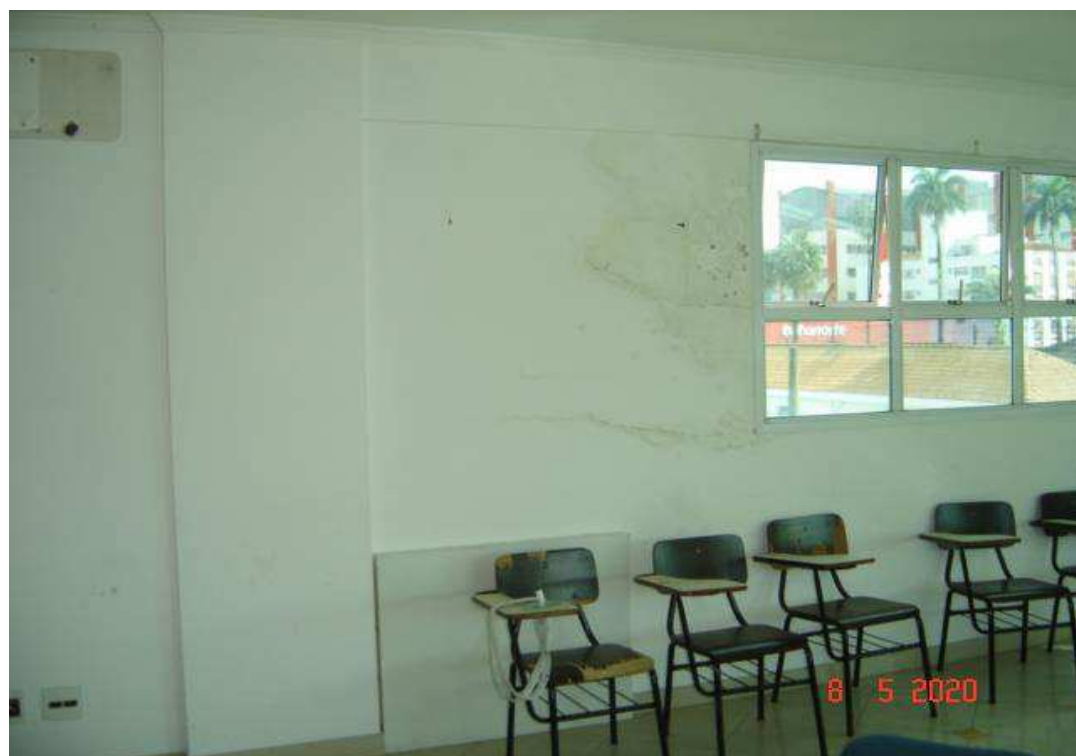
20 – Sala de reuniões. Umidade nas paredes.
