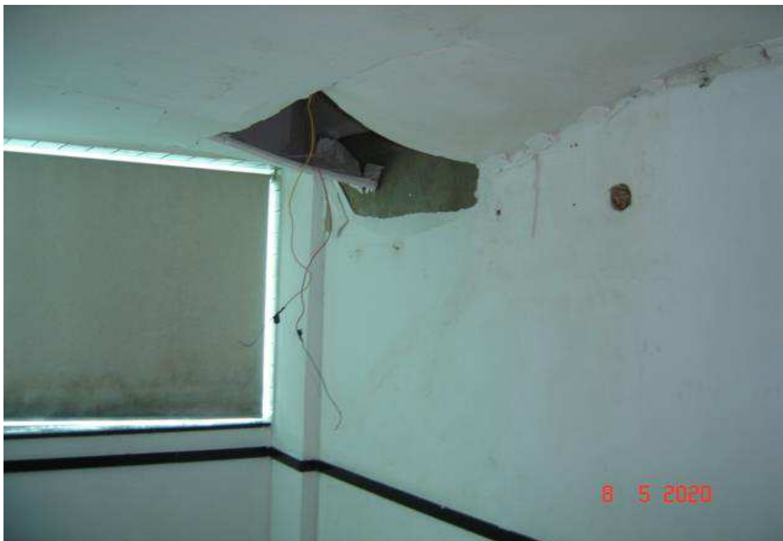
15 – Segundo andar. Queda de forro e descolamento de massa nas paredes, devido a umidade.
