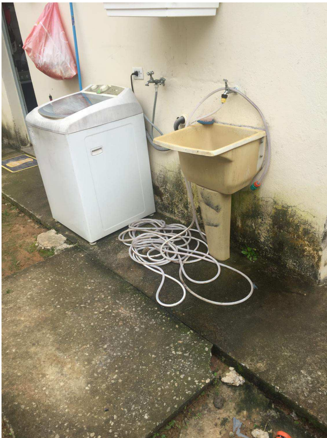
Fig. 8 Foto do quintal, mostra umidade na parte externa, pintura antiga e piso cimentado ao redor do imóvel danificado.
