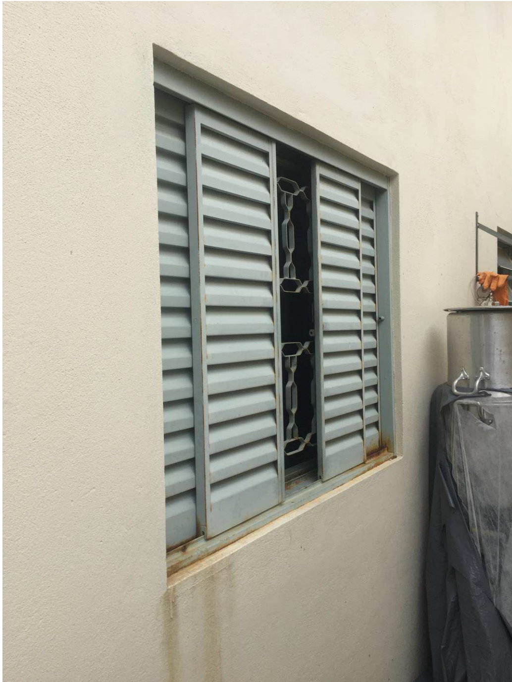
Fig. 6 Foto de uma das janelas de ferro, apresentando pontos de ferrugem.
