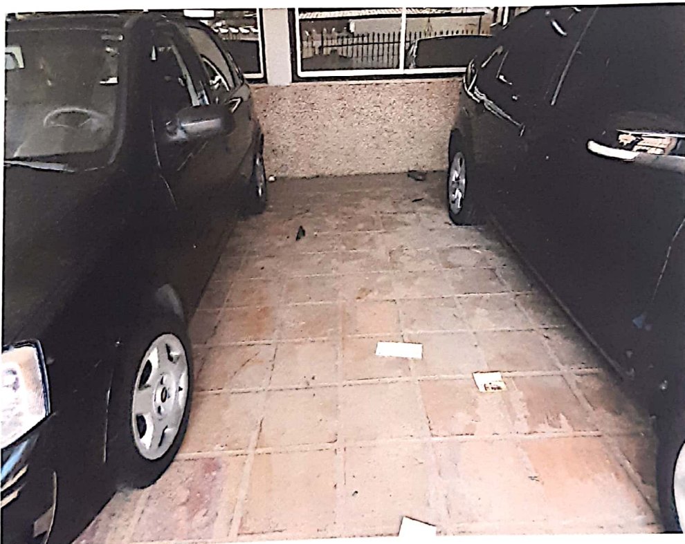
Foto 2- Vista parcial do desgaste do piso da garagem.
