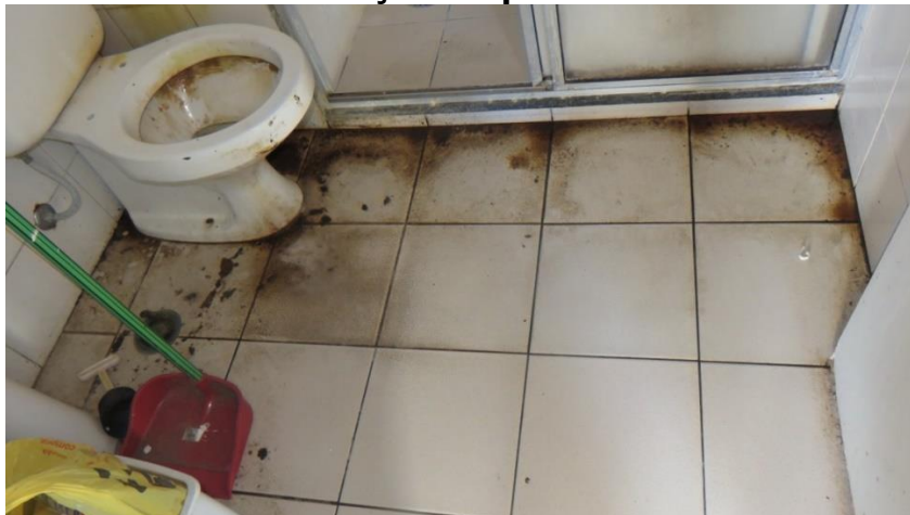
Detalhe das condições do piso e vaso sanitário.
