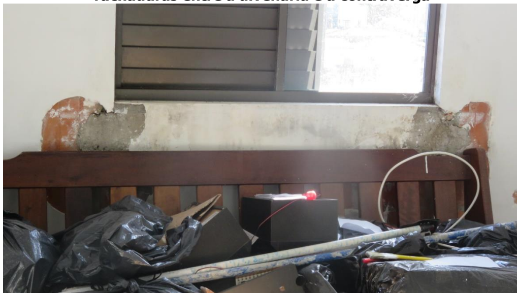
Figura 22: Detalhe das condições da parede do dormitório, observando rachaduras entre a alvenaria e a contraverga
