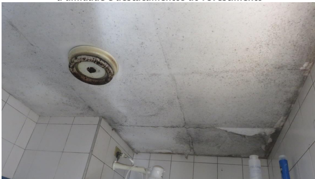
Figura 26: Vista do forro do banheiro com fissuras, manchas de bolor devido à umidade e destacamentos do revestimento
