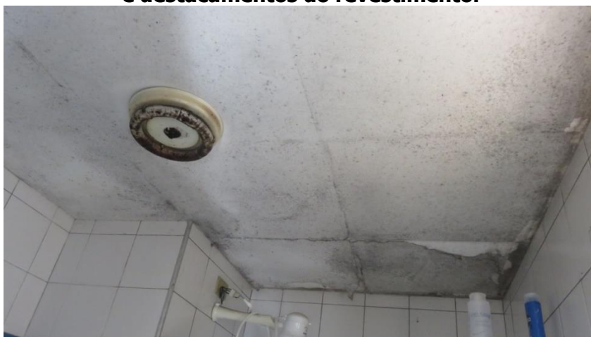
Vista do forro do banheiro com fissuras, manchas de bolor devido à umidade e destacamentos do revestimento.
