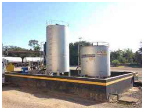
Posto de Abastecimento – Tanques verticais
