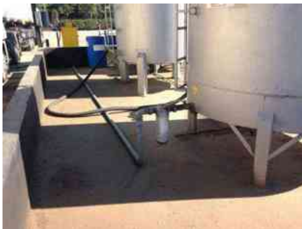
Setor de Abastecimento no imóvel avaliado
