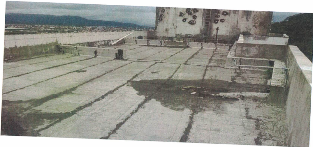
Laje com infiltração - 02
