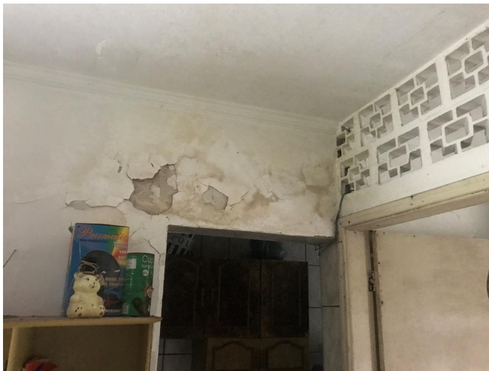
Foto 22 - Revestimento sobre a passagem da porta em péssimo estado
