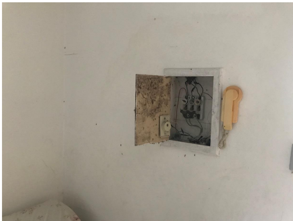
Foto 21 - Detalhe do quadro de disjuntores, totalmente incompatível com as normas técnicas vigentes e de segurança
