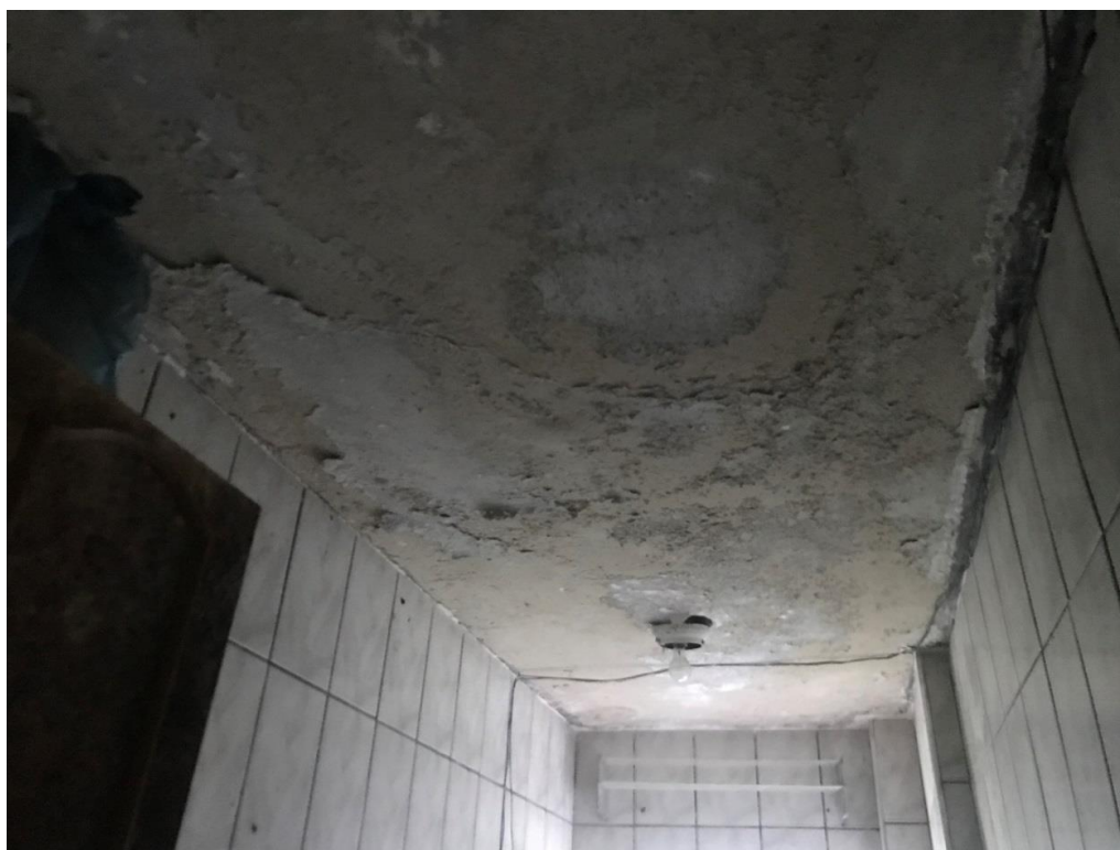
Foto 23 - Teto da cozinha em péssimo estado devido a umidade do pavimento sobrejacente
