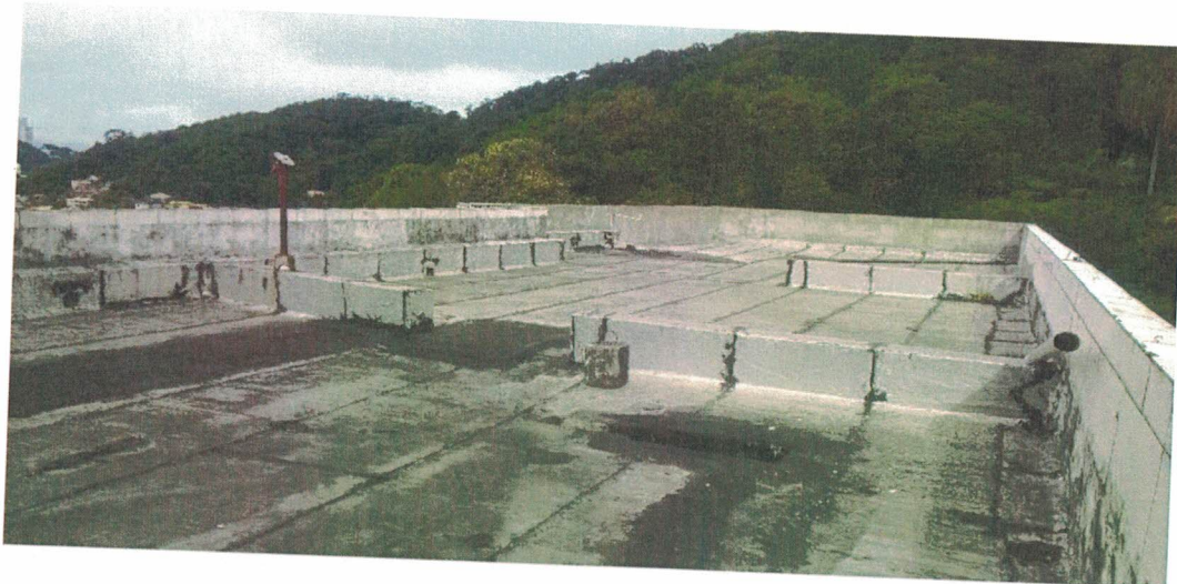
Laje com infiltração - 02
