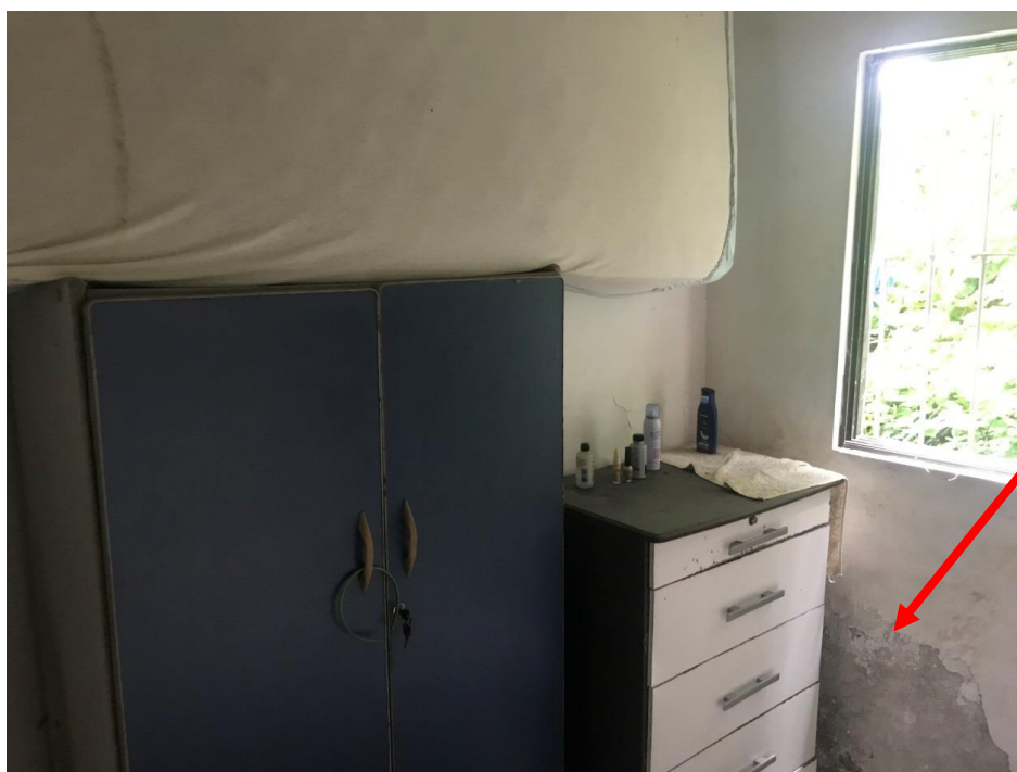
Foto 17 - Revestimento da parede do quarto danificado
