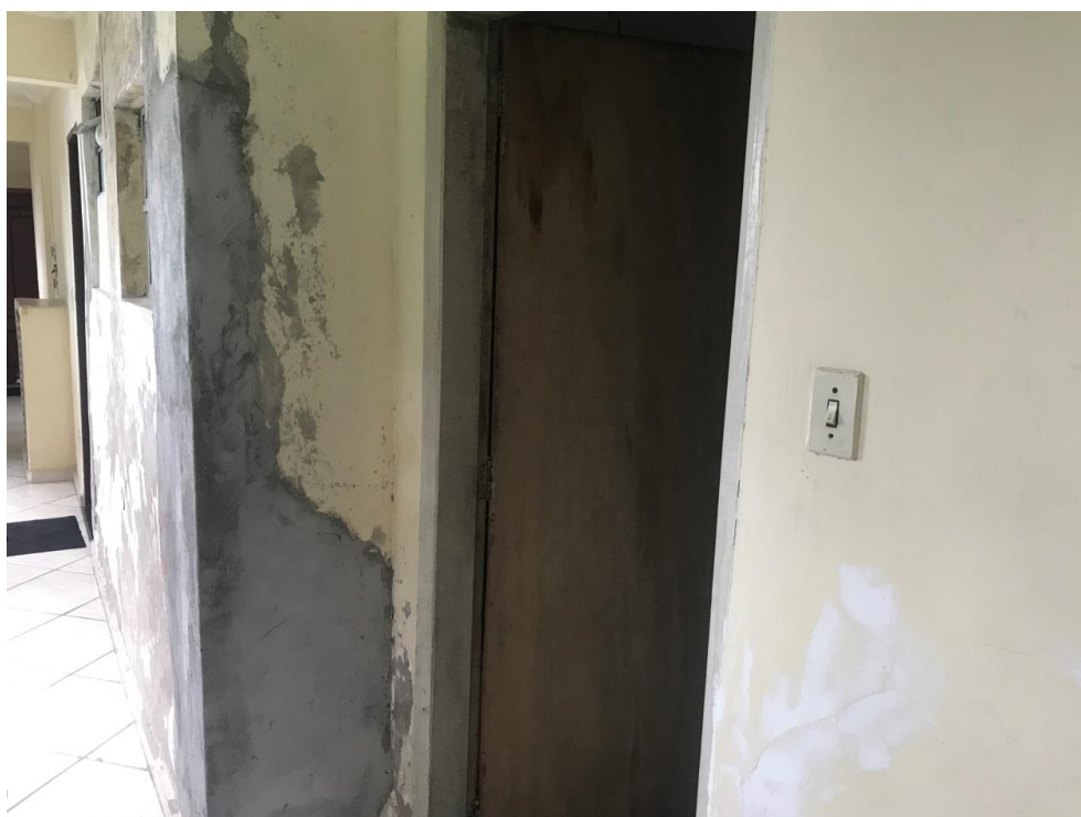
Foto 10 - Porta de entrada do apartamento 406; revestimento da parede foi rebocado recentemente
