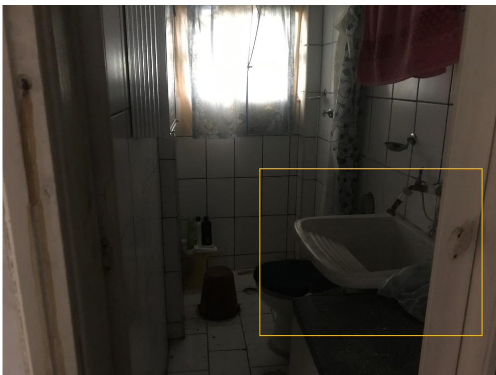
Foto 16 - Vista do banheiro; há um tanque de louça ao invés do lavatório
