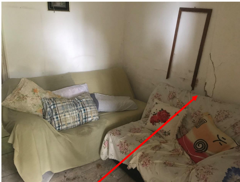
Foto 12 - Danificações no revestimento da parede da sala.
