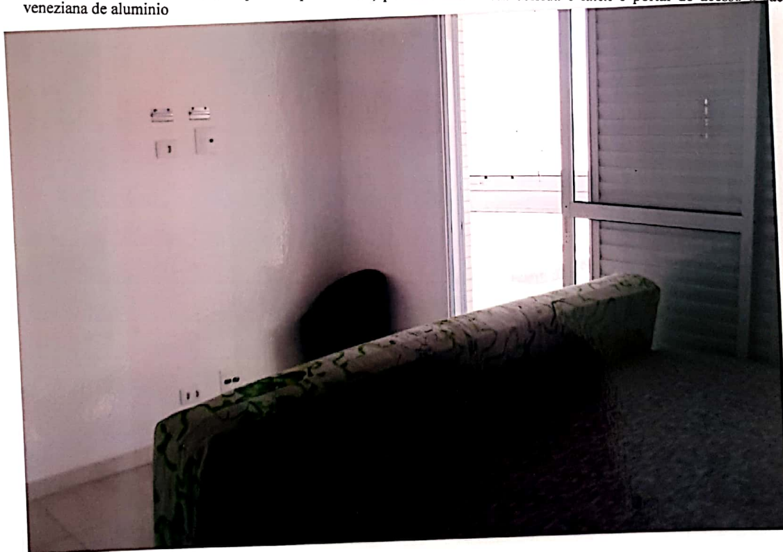
foto nº 27 - dormitório da suíte 3 com piso de porcelanato, paredes com massa corrida e látex e portal de acesso à sacada de veneziana de alumínio
