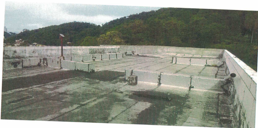
Laje com infiltração - 02
