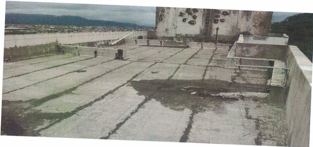
Laje com infiltração - 02
