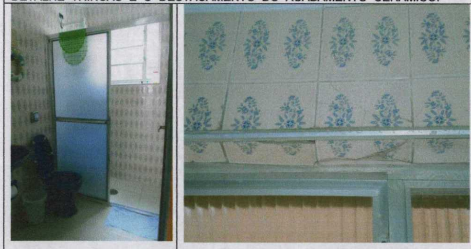
FOTO-SÉRIE 10 - REGISTROS DO ÚNICO BANHEIRO, MOSTRANDO, NO DETALHE TRINCAS E O DESTACAMENTO DO ACABAMENTO CERÂMICO.
