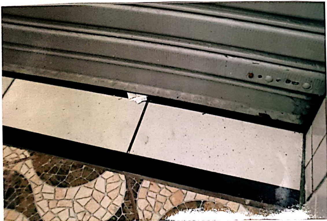
Foto nº6 - Detalhe do piso cerâmico junto à porta de entrada da loja nº 02.
