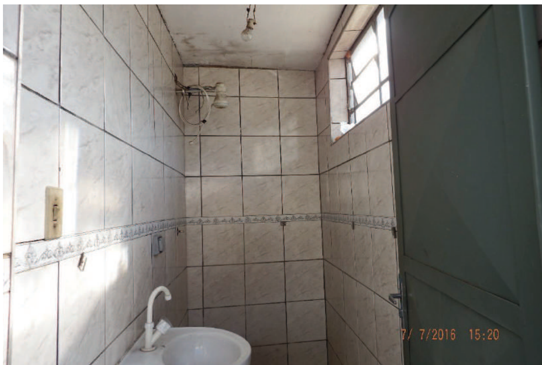
Foto 7- Um dos banheiros existentes do Posto, o outro se encontra com a porta danificada.
