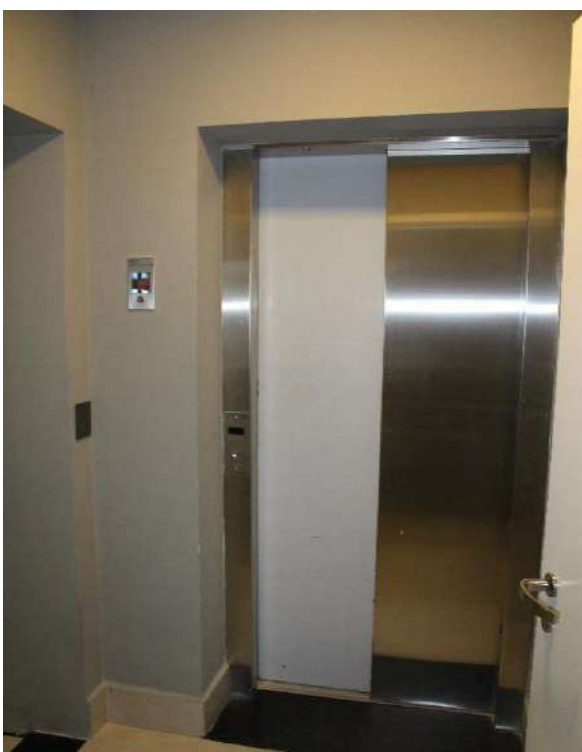
Foto – Elevador de serviço parado, notamos ainda com o envelopamento.
