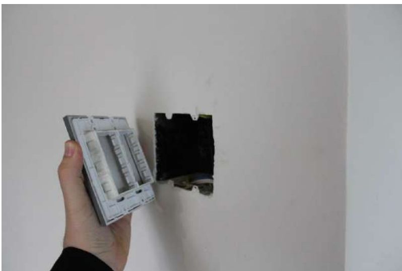
Foto – Caixas soltas, sem fixação e sem instalações, características de uma obra inacabada.
