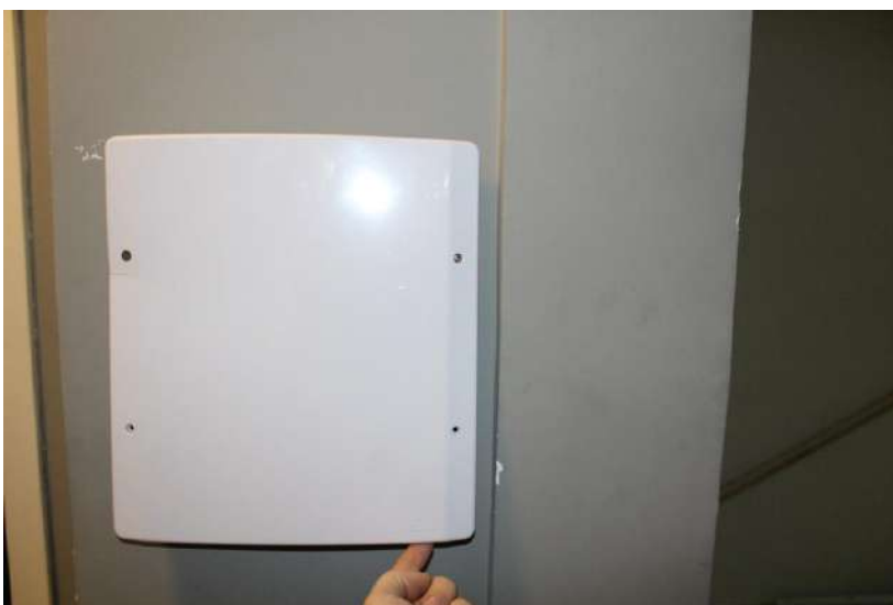
Foto – Quadro elétrico “lacrado”, aparafusado, sem acesso. Não atende a NBR 5410 e a NR10
