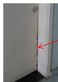
Evidência de má conservação
