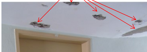
Teto do corredor de acesso do apartamento nº 43B
