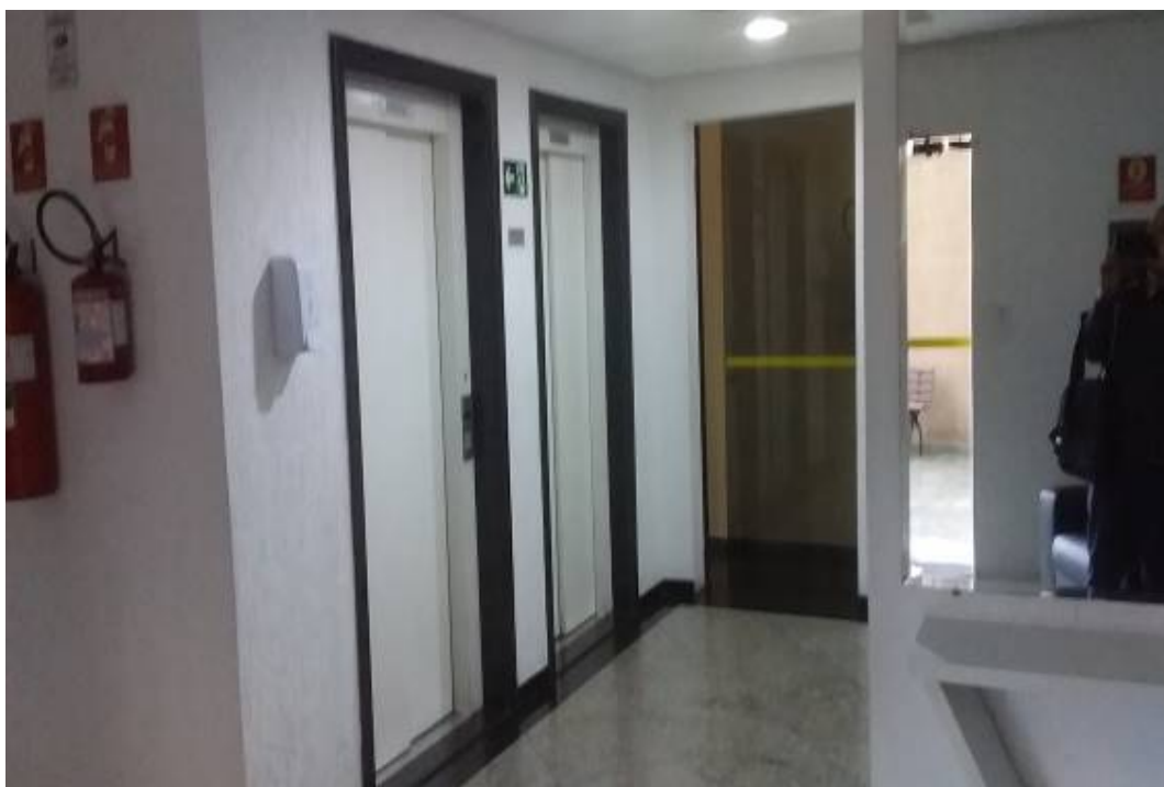
FOTO Nº 09 – Vista dos elevadores de acesso aos pavimentos.
