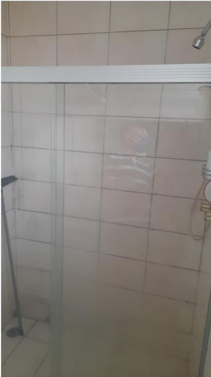
Figura 40 chuveiro do banheiro
