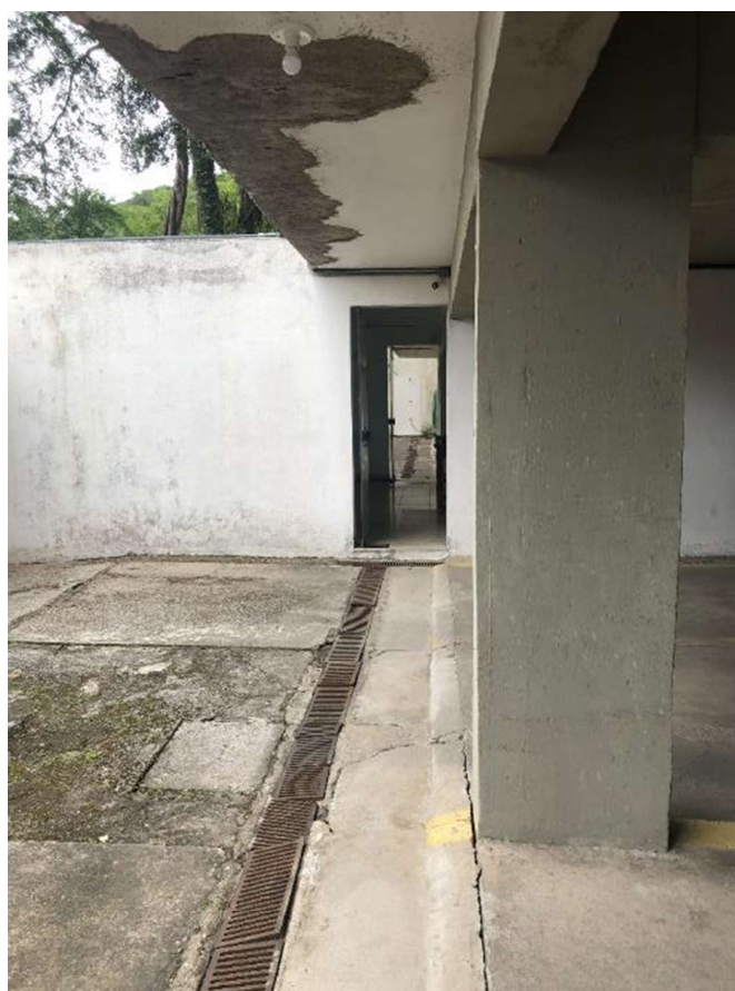
Figura 47 – Garagens Piso degradado e reboco aparente reparo em andamento no superior.
