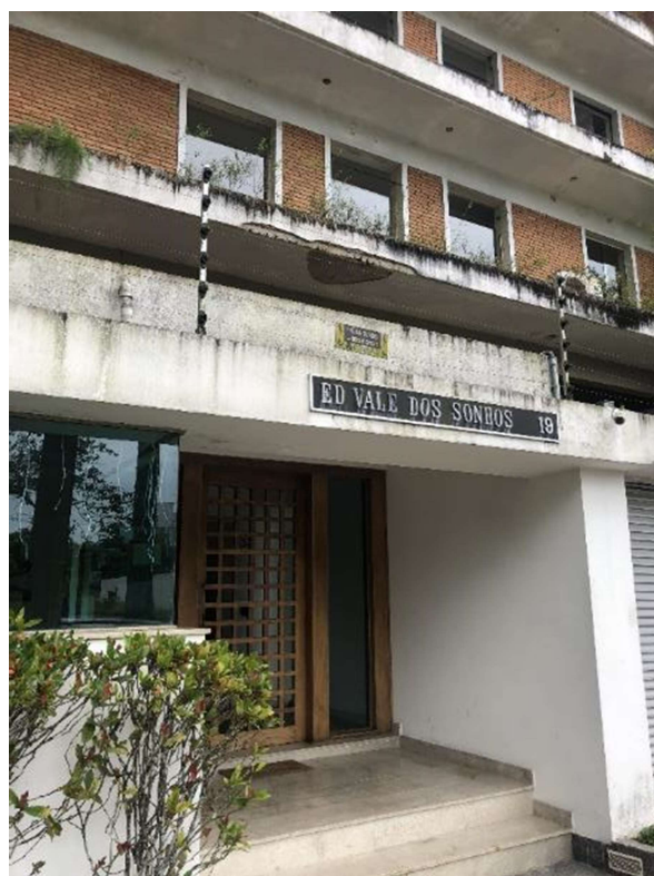
Figura 49 – Fachada, com área descascada e apontamento de exposição de ferragens.
