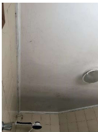
Figura 46 – Detalhe teto forro de gesso com sinais de umidade. Banheiro suíte 2.
