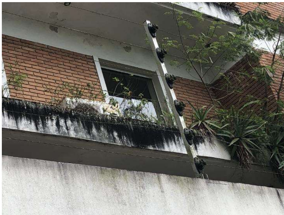
Figura 42 – FACHADA – Sinais de umidade. Pintura degradada.
