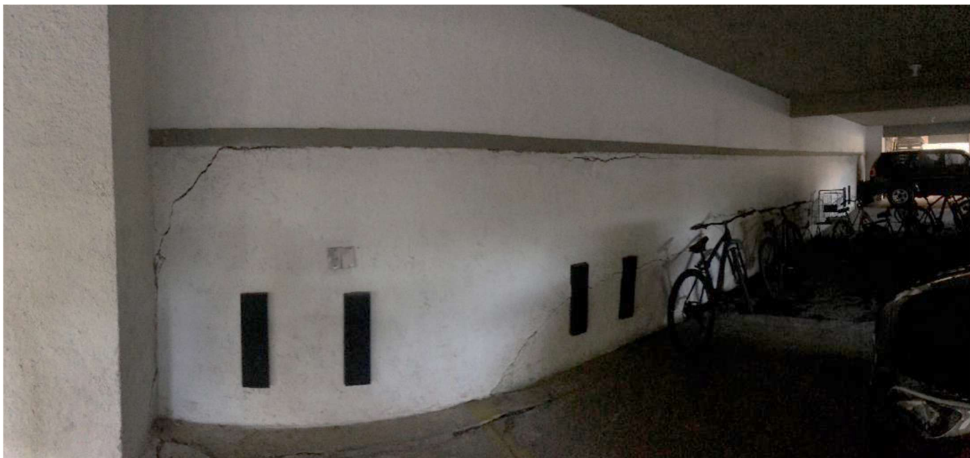
Figura 59 – Garagens, paredes com trincas. (foto acrescentada).
