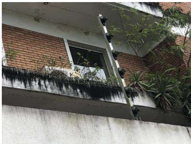
Figura 53 – FACHADA – Sinais de umidade. Pintura degradada.
