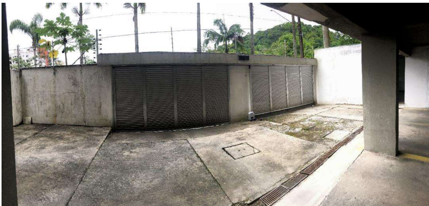
Figura 57 – Garagens Piso degradado sem manutenção. Viga superior descascada.
