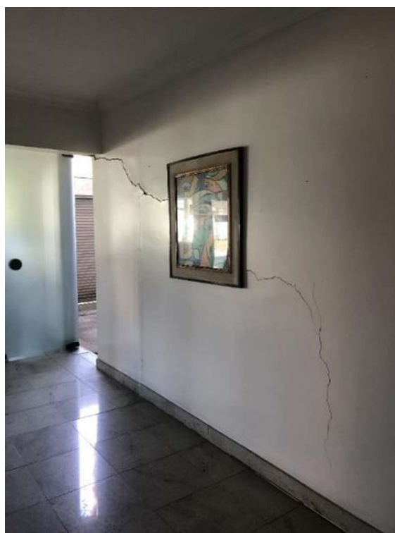
Figura 49 – Ainda no hall de entrada do Edifício, trinca aparentemente com comportamento ativo, ou seja crescente. (foto acrescentada).
