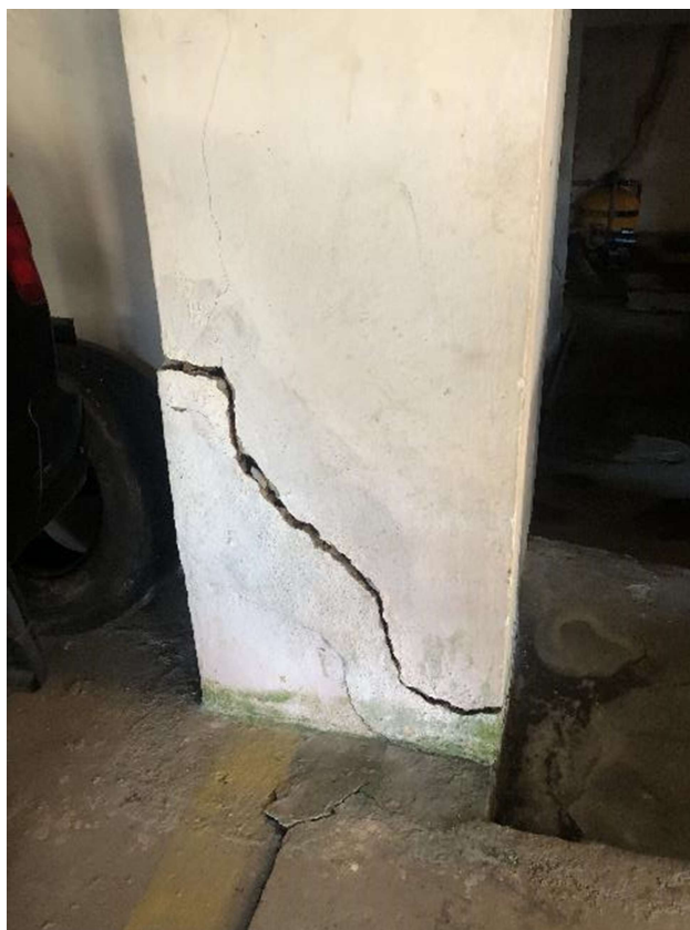
Figura 61 - Pilar trincado próximo a área fechada de "depósito". (foto acrescentada).
