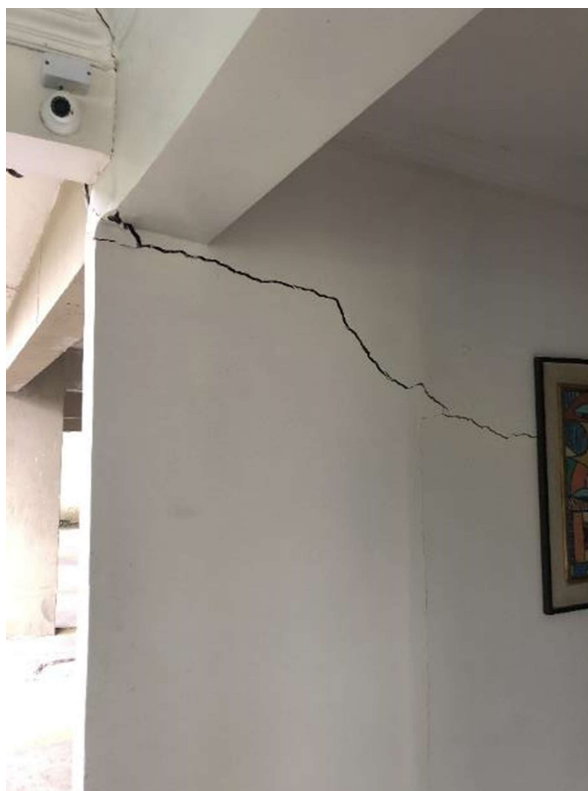
Figura 48 – Ao lado da Garagem no térreo, acesso ao hall de entrada Trica no superior da parede encontro com a viga.
