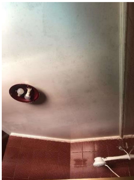
Figura 44 – Detalhe teto, forro de gesso com sinais de umidade. Banheiro Suíte 1.
