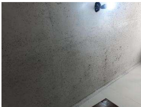
Figura 52 – Detalhe teto de forro de gesso com sinais de umidade, Banheiro Social entre dormitórios 3 e 4.
