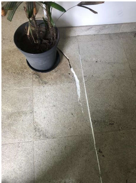
Figura 50 – Piso no hall de entrada do Edifício, rachadura no piso. (foto acrescentada).
