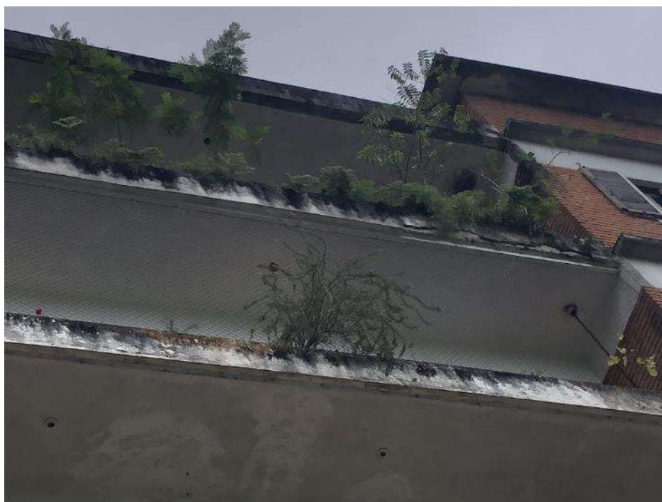
Figura 43 – FACHADA – Sinais de umidade. Pintura degradada e área descascada sem massa.
