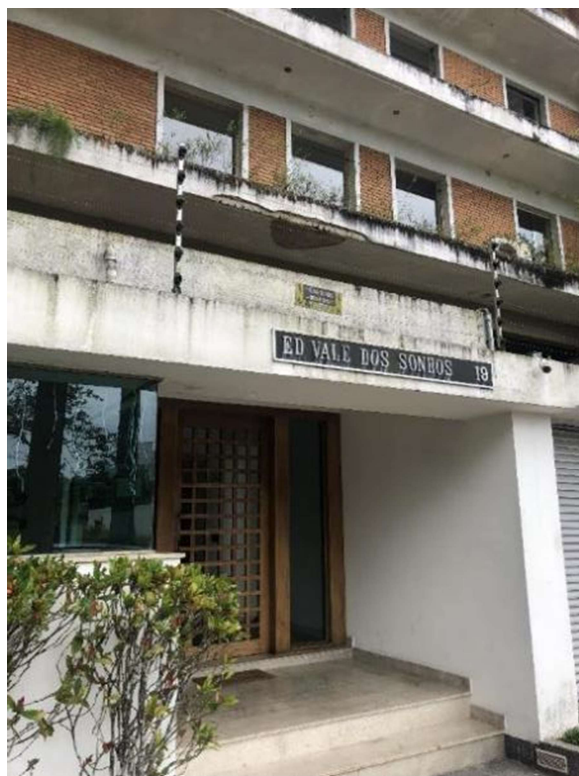
Figura 51 – Fachada, com área descascada e apontamento de exposição de ferragens.
