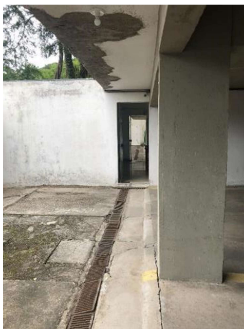
Figura 62 - Garagens Piso degradado e reboco aparente reparo no superior.
