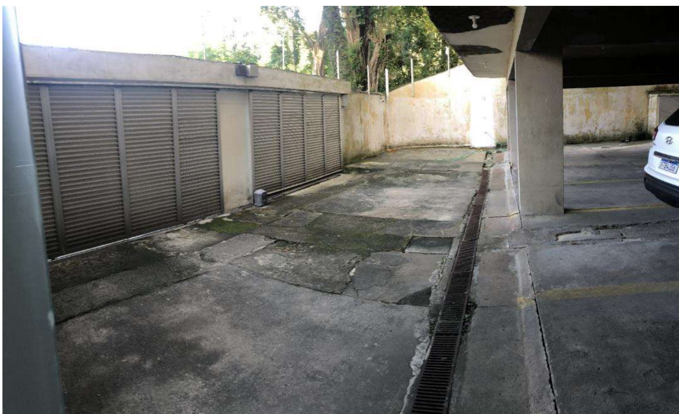
Figura 58 – Garagens Piso solapamento de solo, placas de cimento desniveladas. (foto acrescentada).
