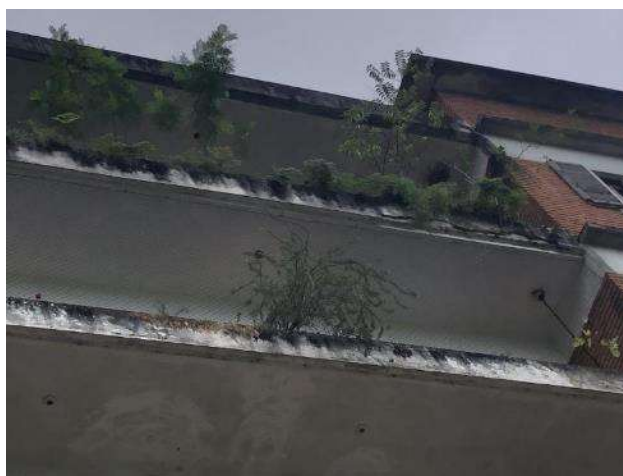
Figura 54 – FACHADA – Sinais de umidade. Pintura degradada e área descascada sem massa.
