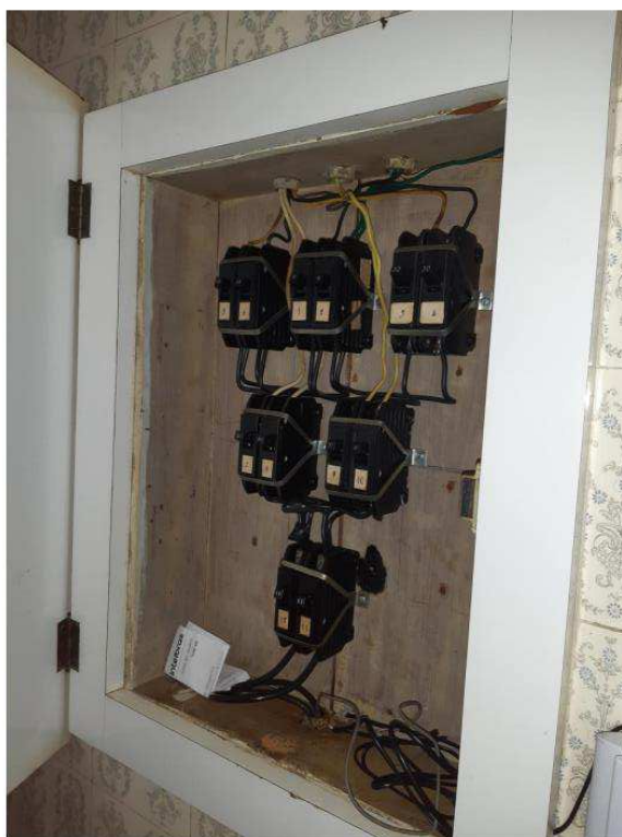
Quadro de energia do apartamento
