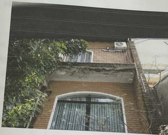
Foto 07 – Outra vista do estado de conservação da laje da sacada.
