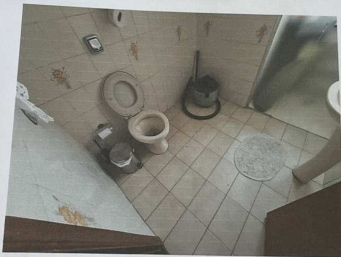
Foto 14 – Vista do banheiro com piso cerâmico, paredes azulejadas até o teto, forro em laje.
