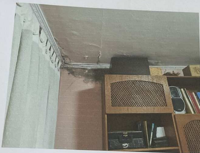
Foto 12 – Vista de manchas de umidade em estado avançado de depreciação além de trincas na laje.
