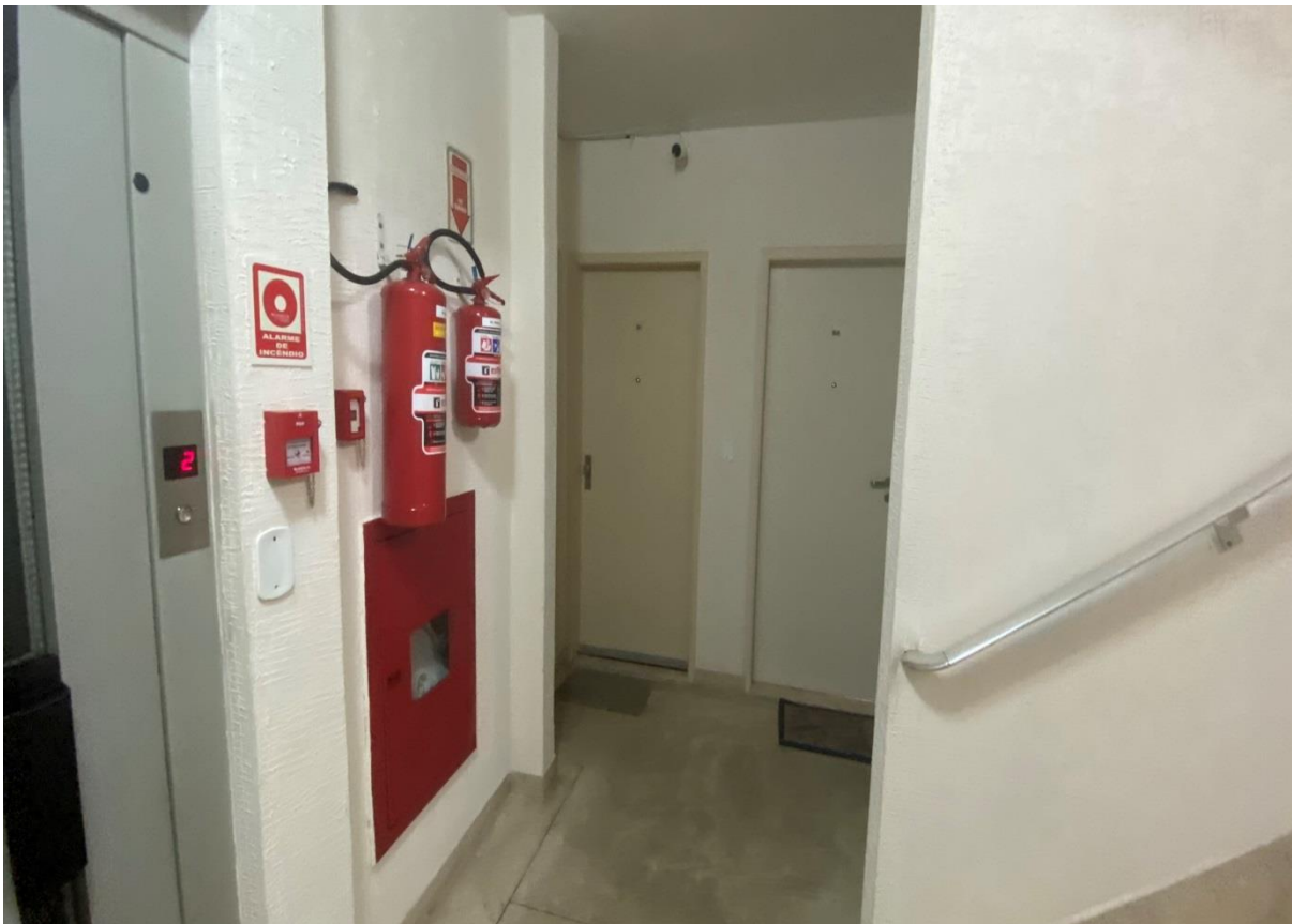
FOTO 13 – Vista parcial do corredor de acesso as unidades privativas do 2º andar.
