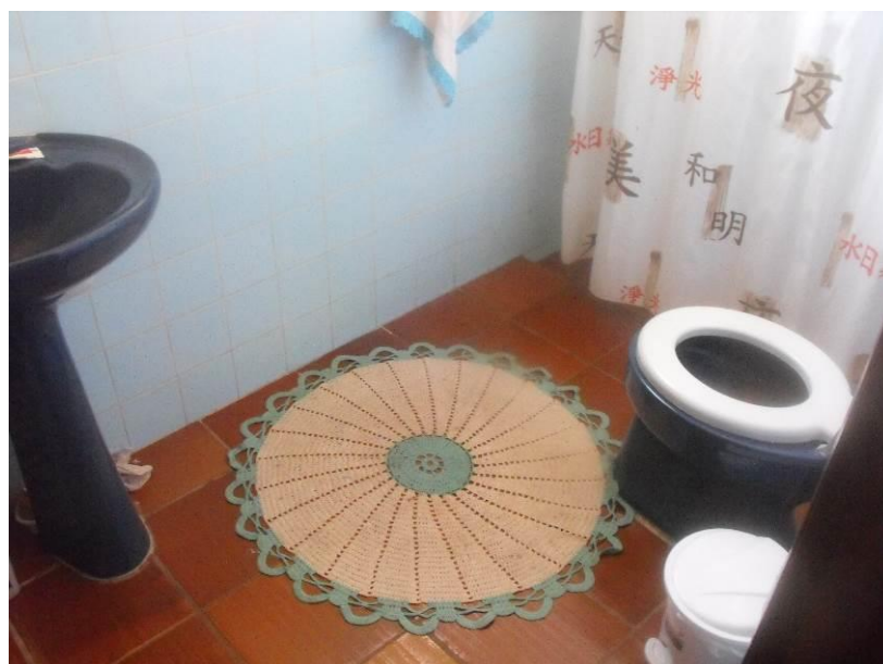
Foto 30 – Mostrando o banheiro da residência, sem azulejos nas paredes.
